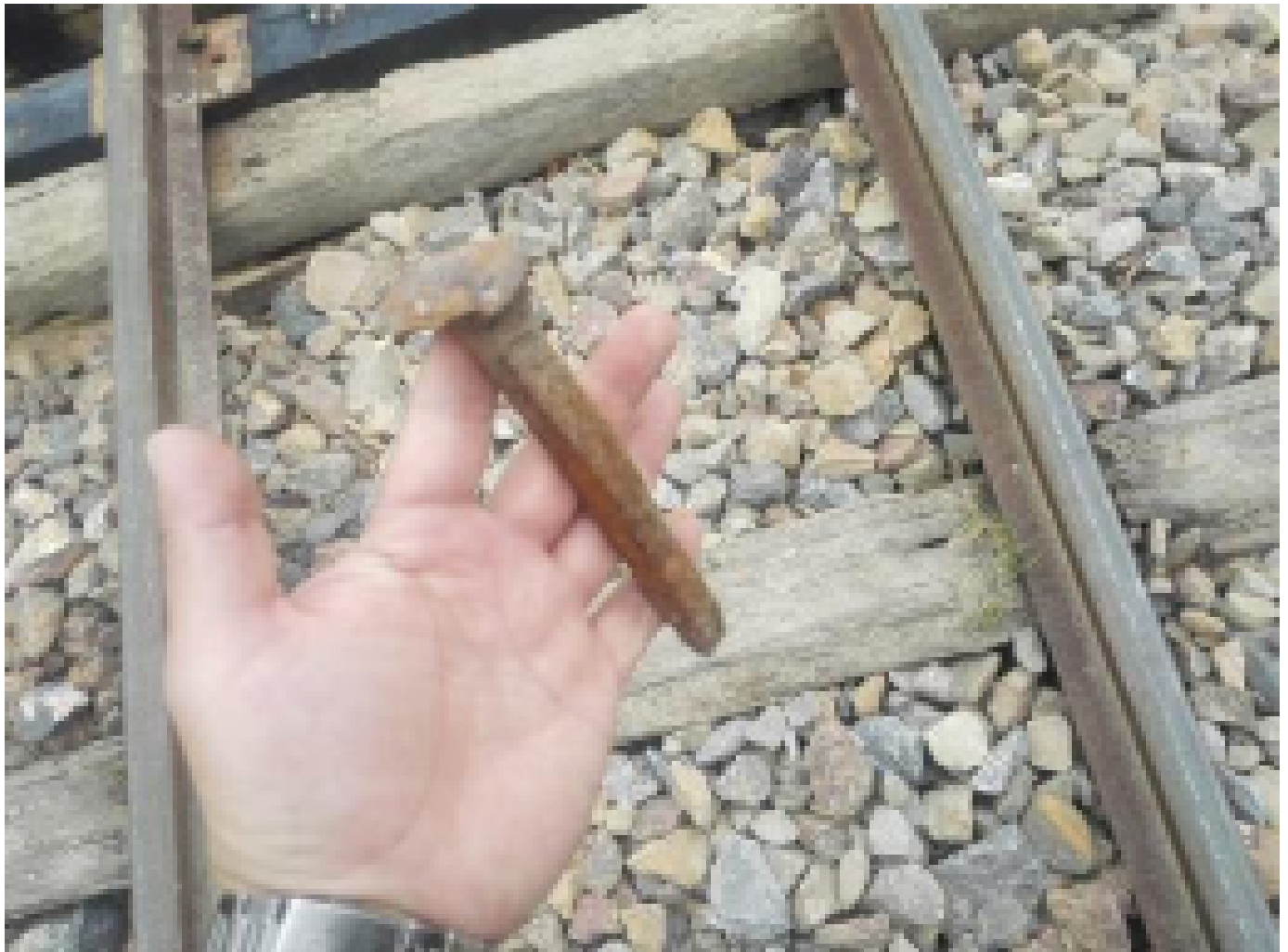
Figura 16 Defecto de no fijación en el durmiente
