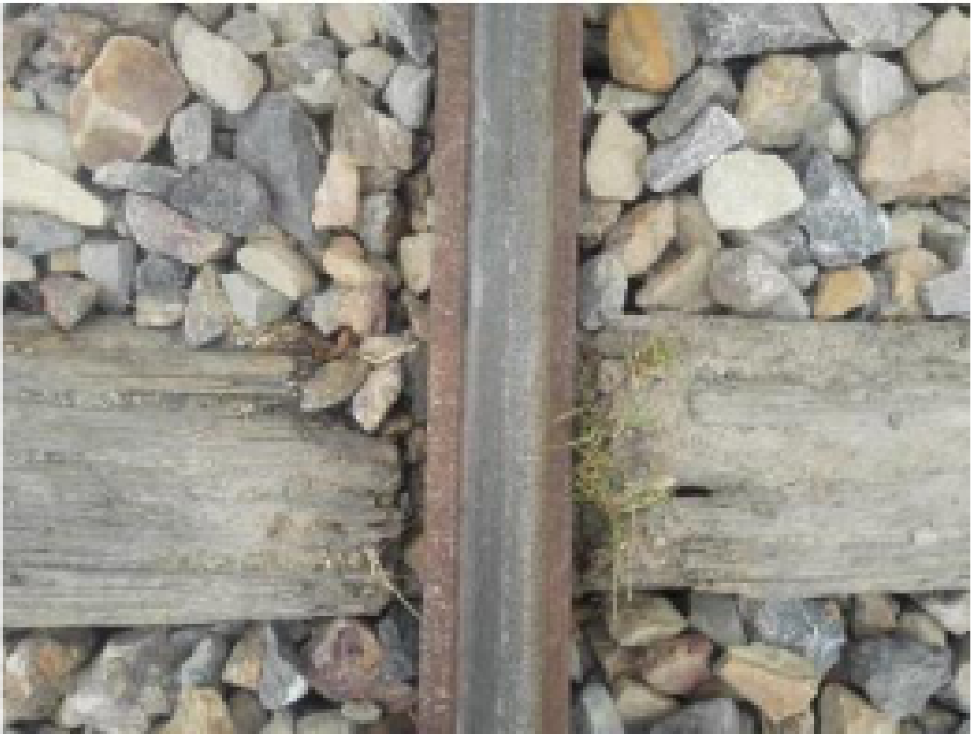
Figura 17 Rompimiento de madera
