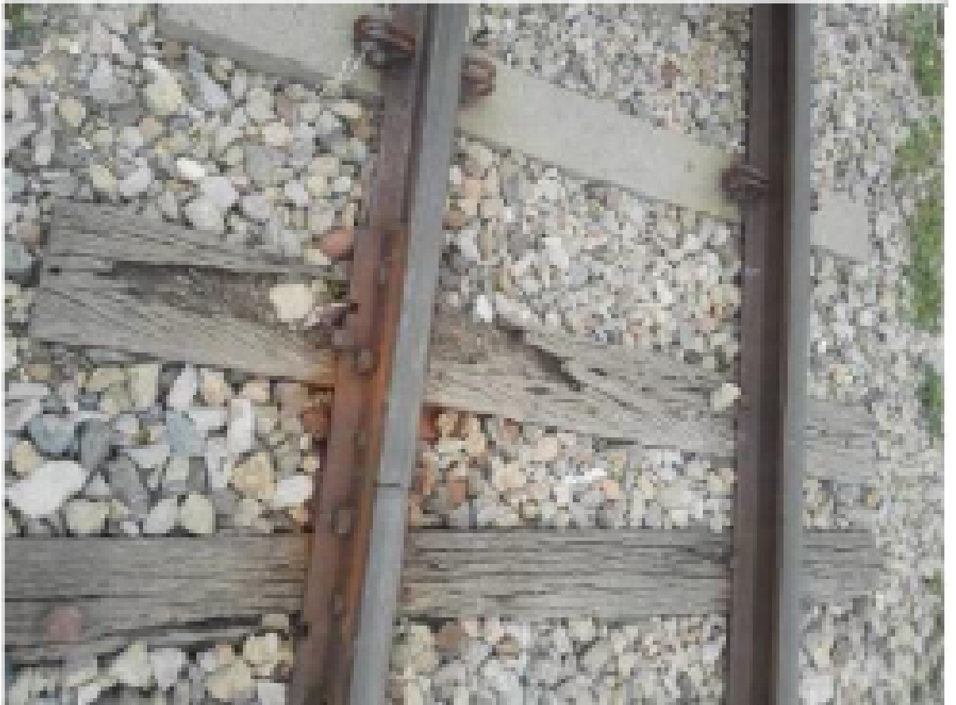
Figura 15 Astilladura e intercalado de durmientes en vía
