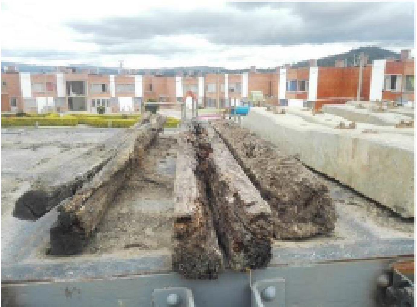
Figura 14 Pudrición del durmiente de madera
