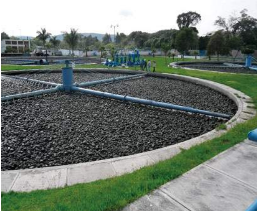
Filtro Biológico (percolador)
