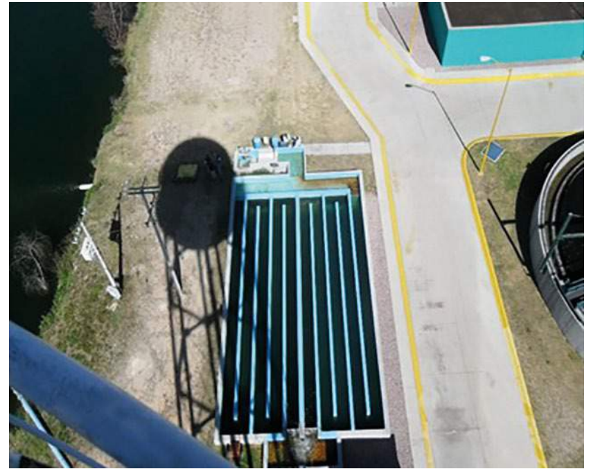
Tanque de contacto con cloro
