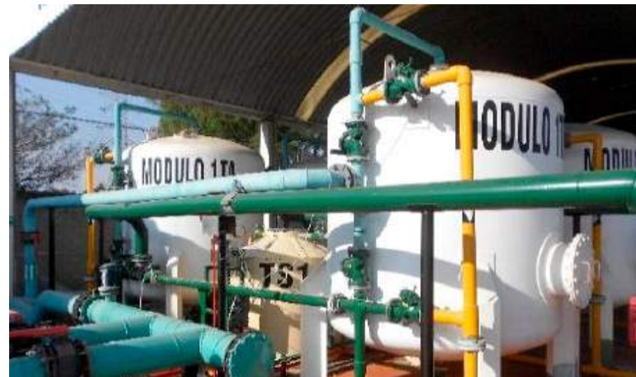
Tanque de Salmuera
