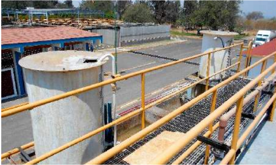
Dosificación de Químicos
