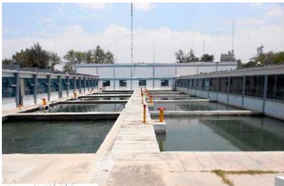
Filtros modulo 1 y 2
