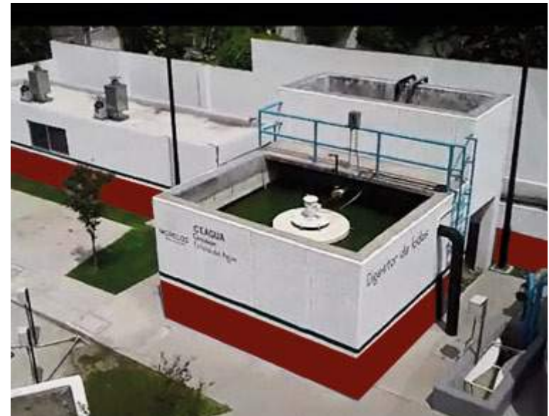
Digestor aerobio de lodos
