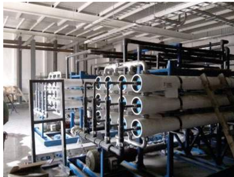
Sistema de ósmosis inversa
