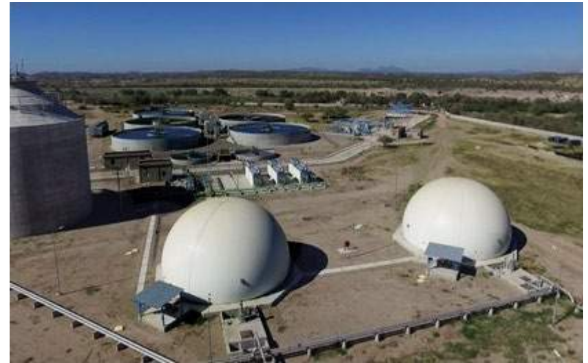
Almacenamiento de biogás y equipos de cogeneración
