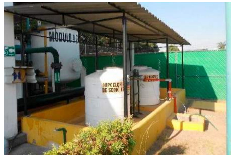
Dosificación de Hipoclorito de Sodio
