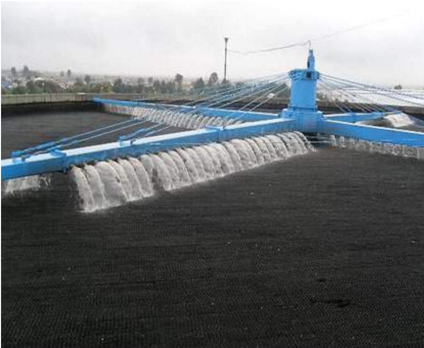
Filtro Biológico (percolador)
