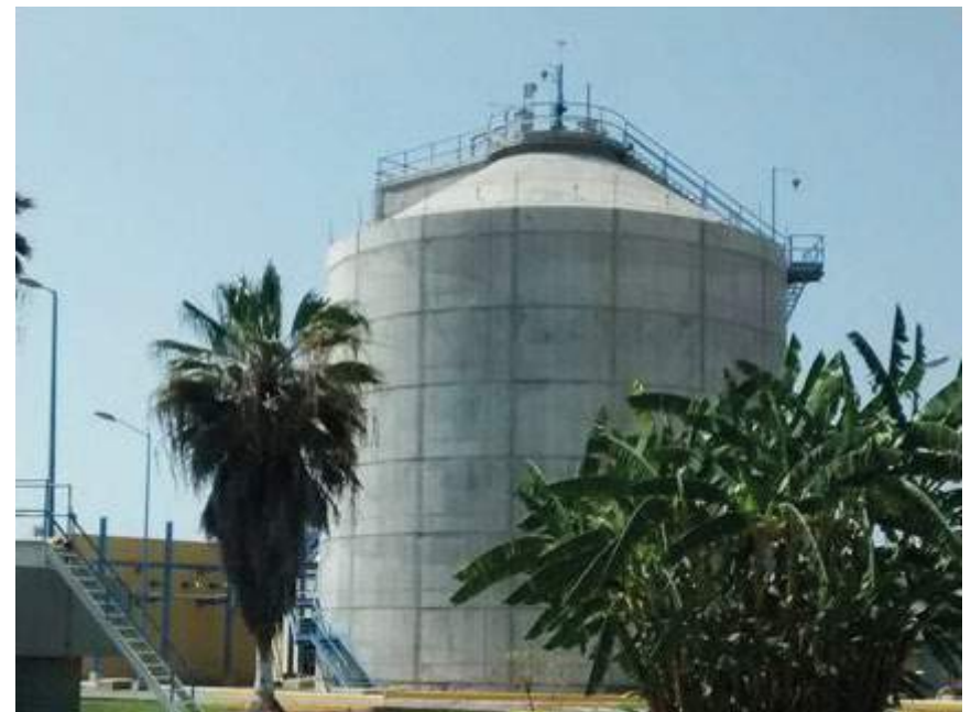
Digestor anaerobio de lodos
