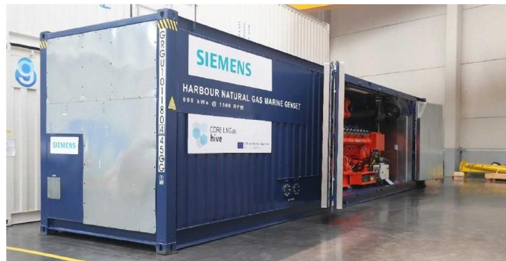
Figura 8: Contenedor alimentado por LNG para dar electricidad (Fuente: Suardiaz)
