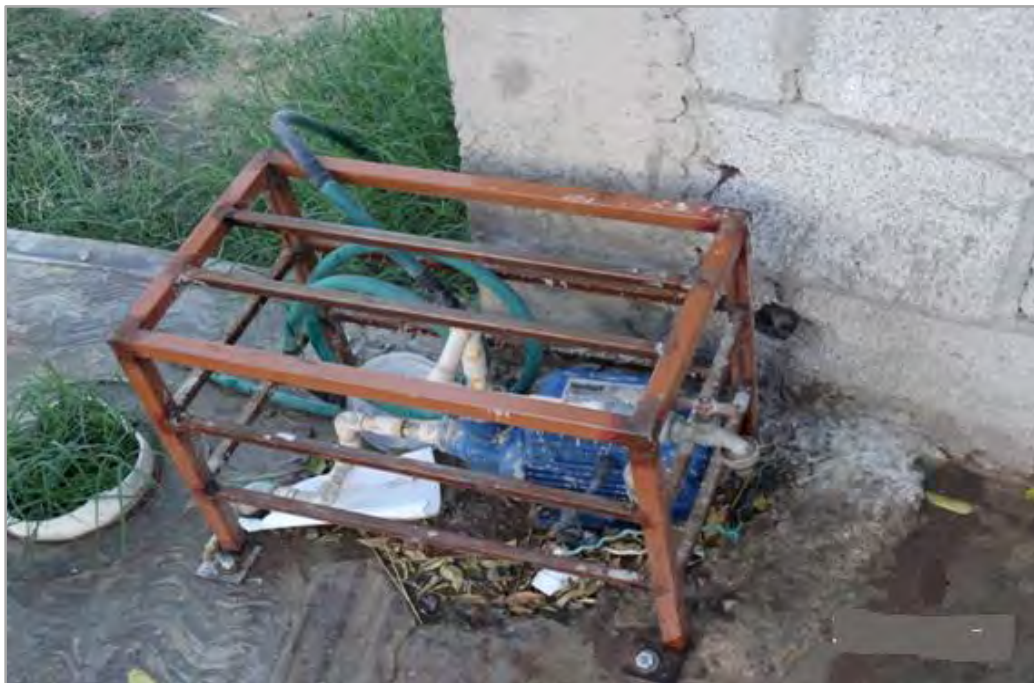
Figura 16. Motobomba conectada a la red
