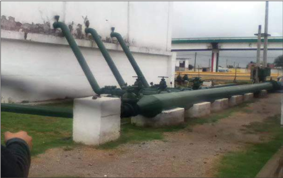
Figura 9. Rebombear del tanque de almacenamiento a la red
