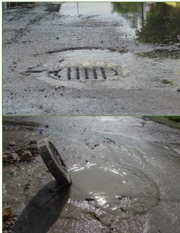
Figura 12. Brote de aguas negras
