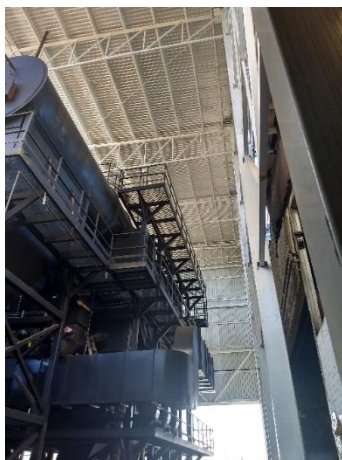
Fotografía 17. Nave industrial y caldera, junio de 2019, Santiago Papasquiario, Dgo. Proyecto Cogeneración de energía para abastecimiento. SEZARIC.
