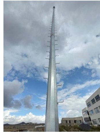
Fotografía 48. Poste colocado, Sistema de tres super postes de 20m de altura para alumbrado exterior alimentado por granja solar, noviembre de 2022, Universidad Autónoma de Zacatecas.
