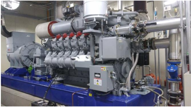
Fotografía 26. Equipo de cogeneración, julio de 2019. Proyecto Apoyo a la Generación Distribuida. FIDE.
