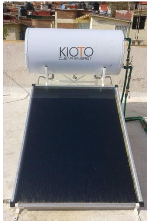
Fotografía 32. Calentador solar de agua en Metepec, Edo. Mex., octubre de 2019. Programa de Mejoramiento Sustentable en Vivienda Existente. FIDE.
