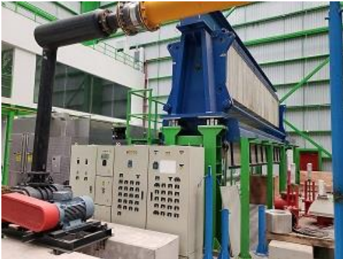
Fotografía 51. Equipo instalado, diciembre de 2022. Proyecto Valorización de fracción orgánica de residuos sólidos urbanos (FORSU) mediante carbonización hidrotermal. UNAM.
