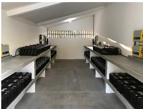
Fotografía 36. Centro de recarga de baterías de El Arcotete, Chis., febrero 2017, Centros Ecoturísticos. Instituto de Energías Renovables del Estado de Chiapas.
