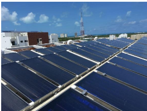
Fotografía 07. Calentamiento de agua del proyecto Calor Solar en el Sector Servicios en Cancún, Q.R. mayo de 2018. CONUEE.
