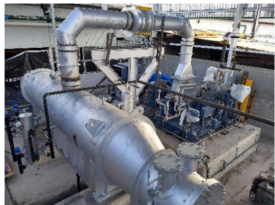
Fotografía 18. Turbina de VSC multietapa de 1000 kW junio de 2019, Santiago Papasquiario, Dgo. Proyecto Cogeneración para abastecimiento. SEZARIC.
