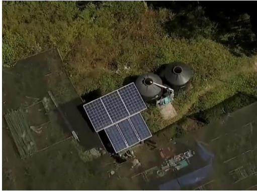
Fotografía 05. Sistema de bombeo de electrificación para procesos productivos en comunidades y zonas rurales aisladas en San Felipe Usila, Oax., junio de 2018. CEGAM.
