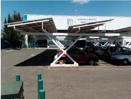
Fotografía 09. Arreglos fotovoltaicos, Aguascalientes, Ags., julio 2018. Proyecto Sustitución del Parque Vehicular a Gasolina por Vehículos Cero Emisiones 100%.
