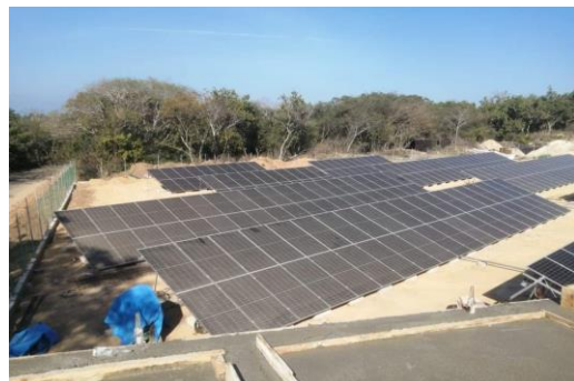
Fotografía 50. Instalaciones del Sistema Fotovoltaico para el bienestar de Colonia Juan N. Álvarez (Playa Ventura) localizada en el Municipio Copala del Estado de Guerrero México, noviembre de 2022, Tecnológico de Acapulco.
