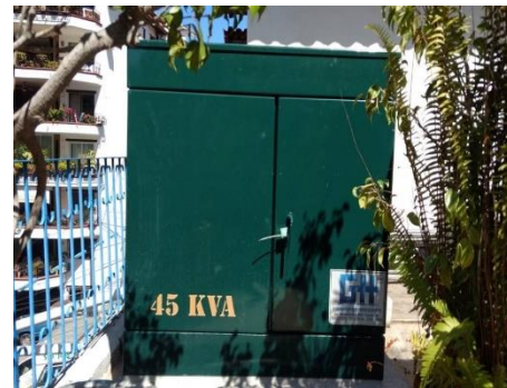
Fotografía 29. Subestación eléctrica, enero de 2018, Proyecto Eco Crédito Empresarial. FIDE.
