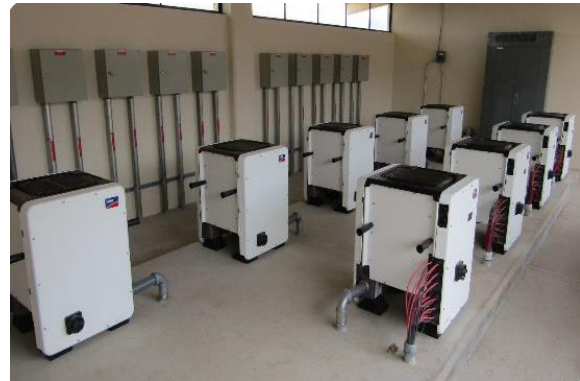
Fotografía 23. Inversores y tablero i-line, junio de 2019, Huajuapán de León, Oax. Proyecto Jardín Solar fotovoltaico de 0.48 MW en la U.T.M.
