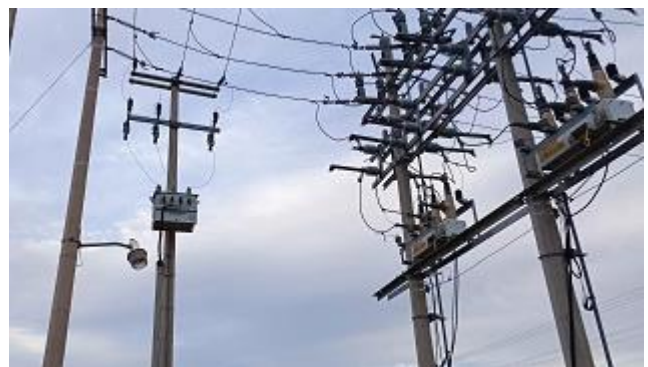
Fotografía 46. Conexión al sistema eléctrico del proyecto Planta Eléctrica Solar para el Centro de Educación Ambiental y Cultural, Isla María Madre, septiembre de 2022. CONANP.
