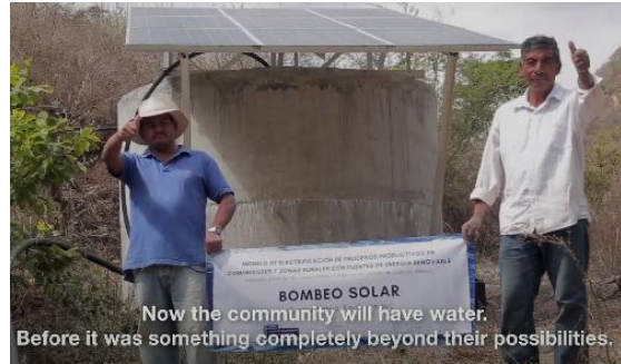
Fotografía 06. Instalación fotovoltaica del proyecto de electrificación de procesos productivos en comunidades y zonas rurales aisladas en San Felipe Usila, Oax., junio de 2018. CEGAM.
