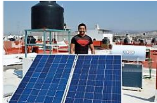
Fotografía 33. Paneles fotovoltaicos en vivienda de Mineral de Reforma Hidalgo, octubre de 2019. Programa de Mejoramiento Sustentable en Vivienda Existente. FIDE.
