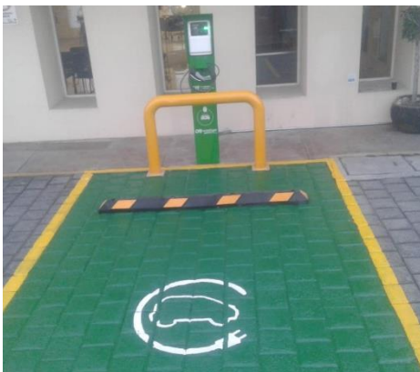
Fotografía 40. Electrolinera en Monterrey, N.L. agosto de 2020. Promoción de la Electromovilidad por Inversión en Infraestructura de Recarga. CFE.
