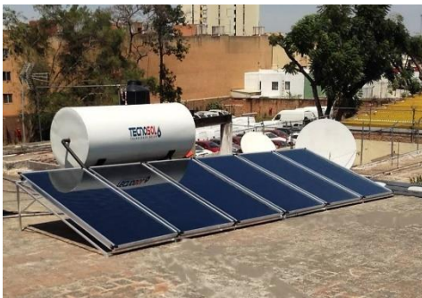
Fotografía 28. Calentador solar de agua en Hospital de Guadalajara, diciembre de 2018. Proyecto Eco Crédito Empresarial. FIDE.
