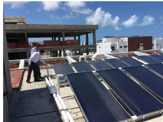
Fotografía 08. Arreglo de las tuberías de agua caliente del proyecto, Calor Solar en el Sector Servicios en Cancún, Q.R., mayo de 2018. CONUEE.
