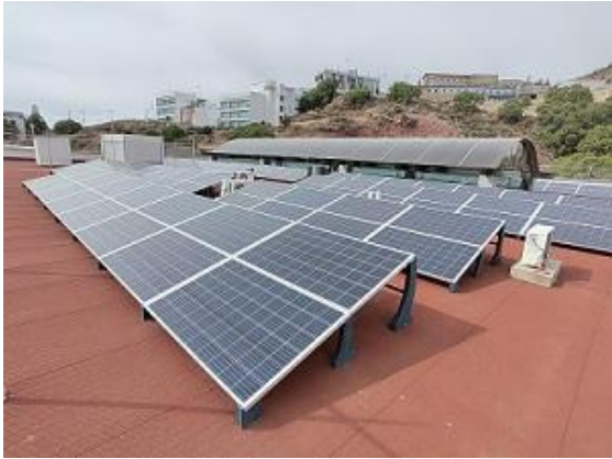
Fotografía 43. Paneles situados en la biblioteca, proyecto Sistemas fotovoltaicos de autoconsumo para la Universidad Autónoma de Zacatecas, octubre de 2022. UAZ
