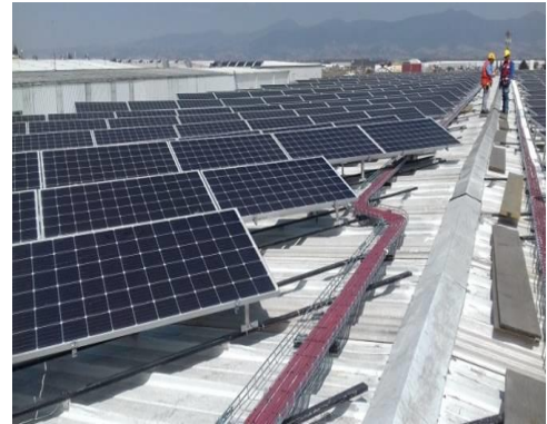
Fotografía 27. Instalación fotovoltaica de MC Plásticos, julio de 2019. Proyecto Apoyo a la Generación Distribuida. FIDE.
