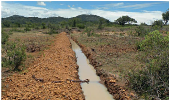
Figura 102. Zanja de desagüe pluvial como medida preventiva.
