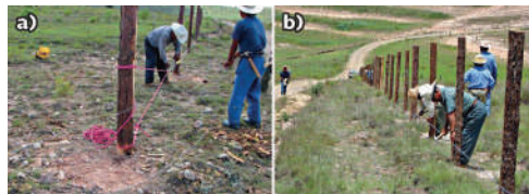
Figura 38. Instalación del cercado: a) tensado del alambre púas, b) fijación al poste.
