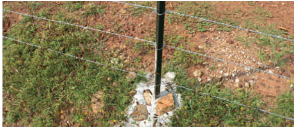
Figura 37. Relleno de la cepa con hormigón para una mayor fijación del poste.
