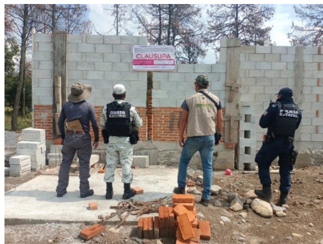
Obra sin autorización clausurada dentro del Parque Nacional La Malinche
