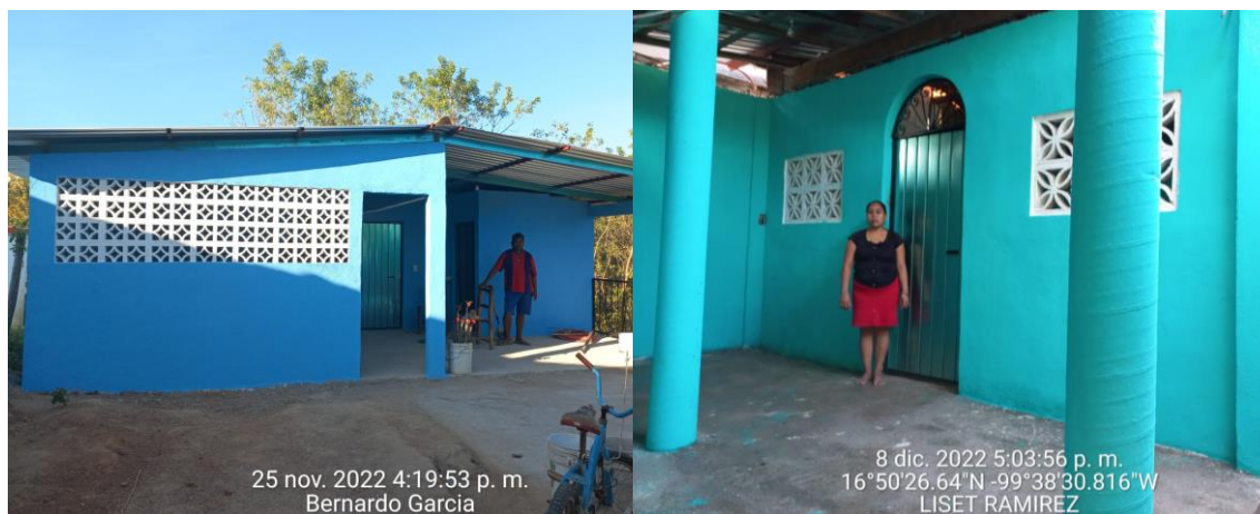
Figura 6. Viviendas concluidas afectadas por el temblor del 7 de septiembre de 2021.
