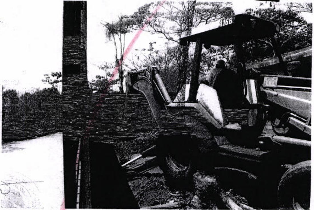
3. FOTOGRAFÍA DEL PROCEDIMIENTO DE EXCAVACIÓN EN LA ZONA DONDE SE INHUMARAN LOS RESTOS ÓSEOS.
