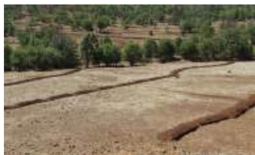
Imagen 61. Ejido Chineachi, municipio de Carichi, Chih. Obra de restauración de suelo: zanja bordo en curvas a nivel.
