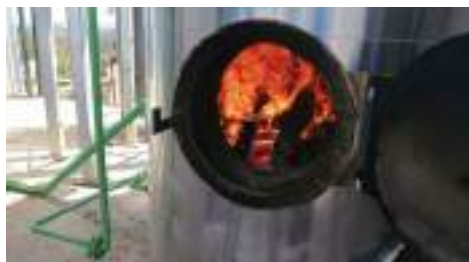
Imagen 130. Caldera de biomasa como fuente de energía.
