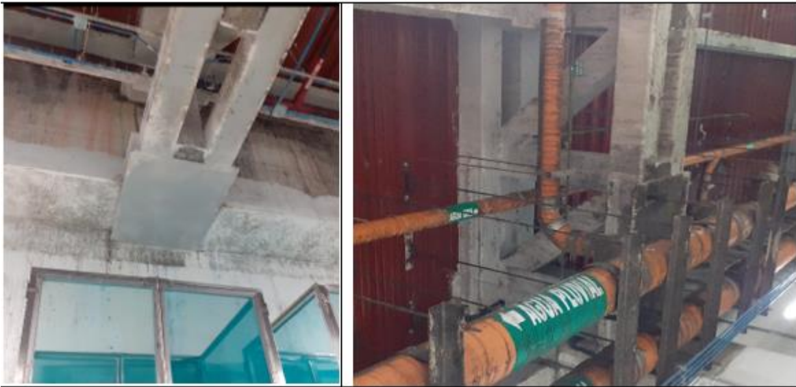
Figura 6: Manchas de moho en las instalaciones por donde pasan los tubos que llevan el vapor caliente generado del tratamiento hidrotérmico dado a los desechos de la dieta larvaria a través del extruder.
