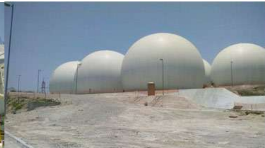
Almacenamiento de biogás
