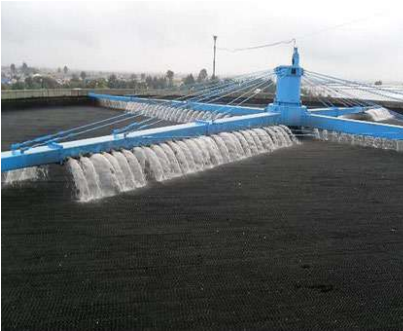
Filtro Biológico (percolador)
