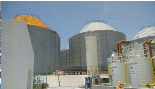
Digestor anaerobio de lodos
