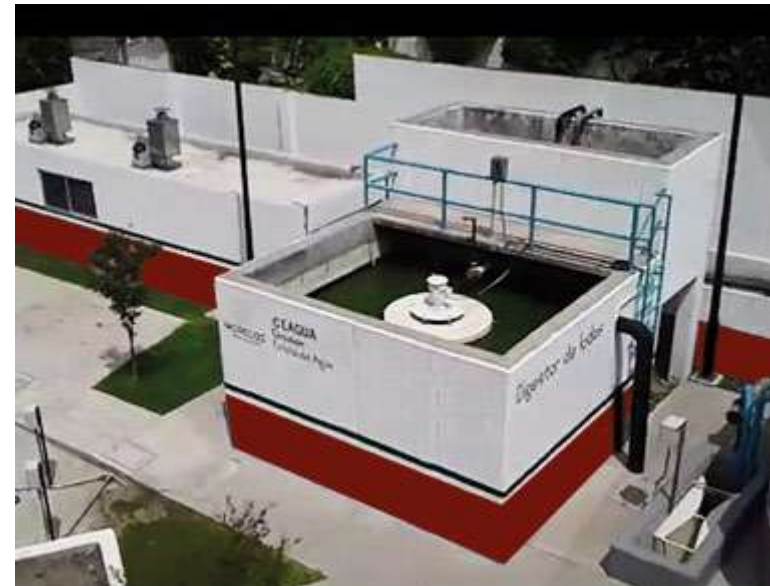
Digestor aerobio de lodos
