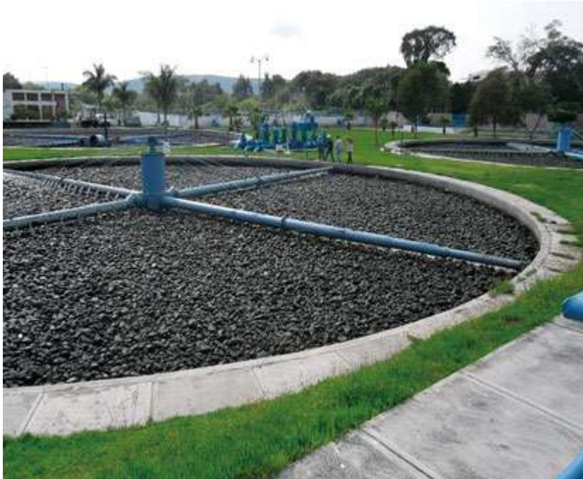
Filtro Biológico (percolador)
