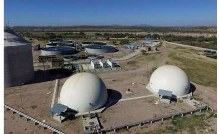
Almacenamiento de biogás y equipos de cogeneración
