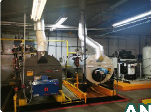
Figura 12 “Fortalecimiento del cuarto de máquinas”
