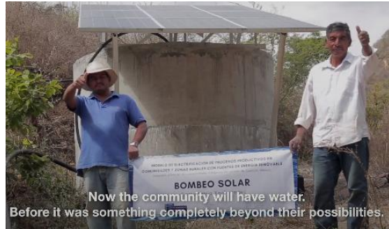
Fotografía 06. Instalación fotovoltaica del proyecto de electrificación de procesos productivos en comunidades y zonas rurales aisladas en San Felipe Usila, Oax., junio de 2018. CEGAM.
