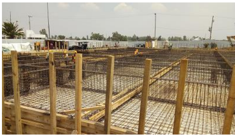
Fotografía 32. Cimentación para elementos estructurales, Bordo oriente, Etapa IV, diciembre de 2020. Proyecto Valorización de fracción orgánica de residuos sólidos urbanos (FORSU) mediante carbonización hidrotermal. UNAM.
