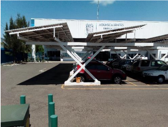
Fotografía 09. Arreglos fotovoltaicos, Aguascalientes, Ags. Julio 2018. Proyecto Sustitución del Parque Vehicular a Gasolina por Vehículos Cero Emisiones 100%.
