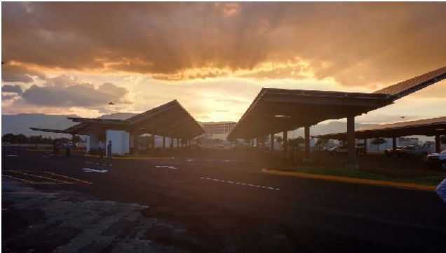
Fotografía 11. Sistema de Producción de Energía Eléctrica, Cd. Victoria, Tamps., diciembre de 2016. Proyecto Parque Fotovoltaico. en Ciudad Victoria, Tamaulipas
