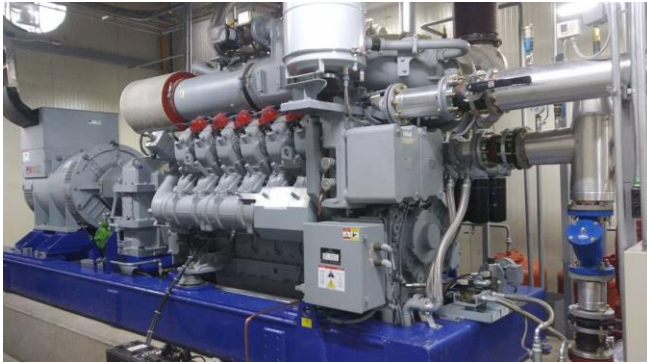
Fotografía 24. Equipo de cogeneración, julio de 2019. Proyecto Apoyo a la Generación Distribuida. FIDE.
