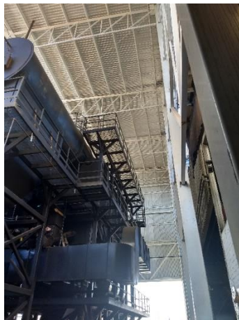
Fotografía 17. Nave industrial y caldera, junio de 2019, Santiago Papasquiari, Dgo. Proyecto Cogeneración de energía para abastecimiento. SEZARIC.
