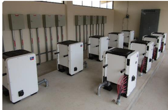
Fotografía 21. Inversores y tablero i-line, junio de 2019, Huajuapán de León, Oax. Proyecto Jardín Solar fotovoltaico de 0.48 MW en la U.T.M.
