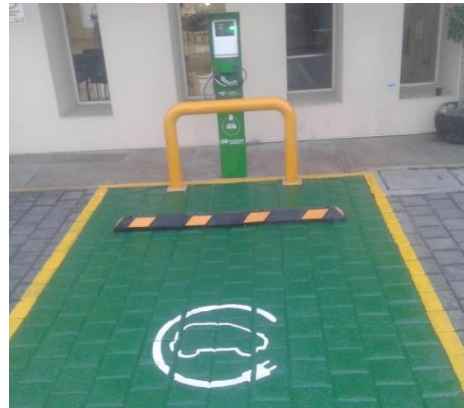
Fotografía 38. Electrolinera en Monterrey, N.L. agosto de 2020. Promoción de la Electromovilidad por Inversión en Infraestructura de Recarga. CFE.
