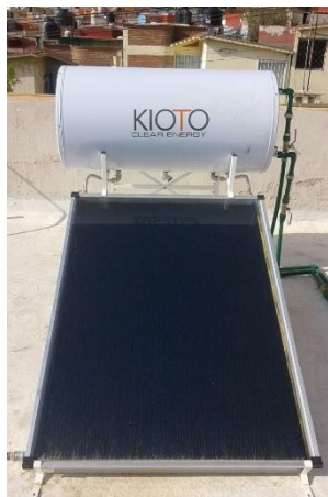
Fotografía 28. Calentador solar de agua en Metepec, Edo. Mex., octubre de 2019. Programa de Mejoramiento Sustentable en Vivienda Existente. FIDE.
