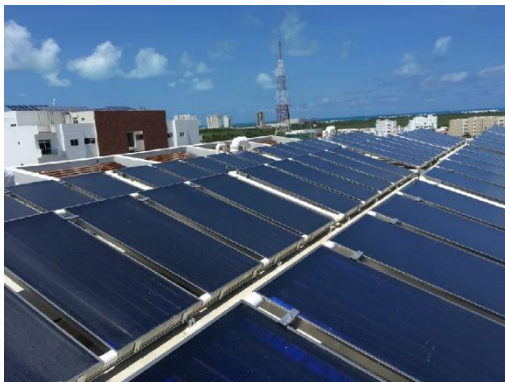
Fotografía 07. Calentamiento de agua del proyecto Calor Solar en el Sector Servicios en Cancún, Q.R. mayo de 2018. CONUEE.
