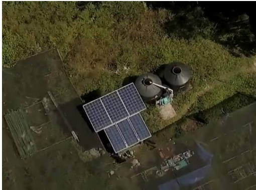
Fotografía 05. Sistema de bombeo del de electrificación del proyecto de procesos productivos en comunidades y zonas rurales aisladas en San Felipe Usila, Oax., junio de 2018. CEGAM.
