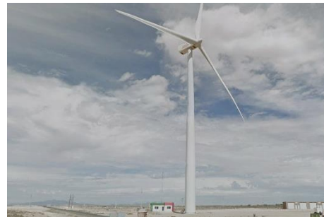
Fotografía 16. Aerogenerador de 2.0 MW, capacidad nominal de 9,533 MWh/año, Puerto Peñasco, Son., mayo 2017, proyecto Energía Sonora PPE, S.C.
