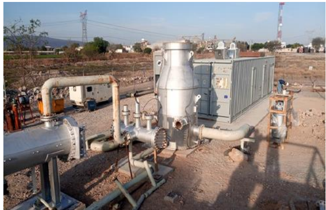
Fotografía 23. Instalación y pruebas con vapor geotérmico en condiciones reales de campo de la unidad BPU 500 kW Proyecto Mecanismo de Fondo revolvente para el Financiamiento.
