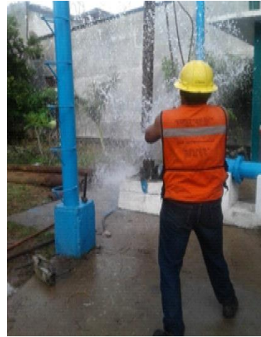
Fotografía 37. Mejora en bombeo Sistema de Agua Potable y Alcantarillado (SAPA), de Juchitán de Zaragoza, Oax., abril de 2019. Eficiencia energética en servicios públicos en el Istmo de Tehuantepec. CONUEE.
