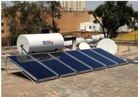
Fotografía 26. Calentador solar de agua en Hospital de Guadalajara, diciembre de 2018. Proyecto Eco Crédito Empresarial. FIDE.
