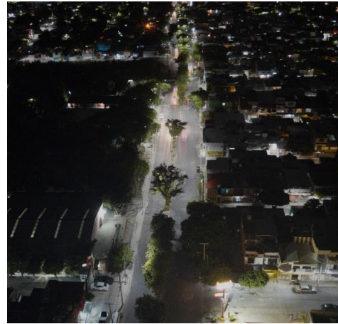
Fotografía 31. Avenidas iluminadas por tecnología LED en Tuxtla Gutierrez, Chis., diciembre de 2020. Proyecto Nacional de Eficiencia Energética en el Alumbrado Público. CONUEE.
