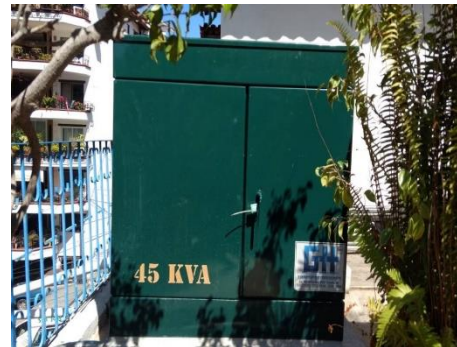
Fotografía 27. Subestación eléctrica, enero de 2018, Proyecto Eco Crédito Empresarial. FIDE.
