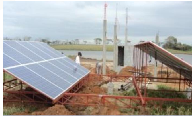
Bombeo solar para 100 m 3 /d
