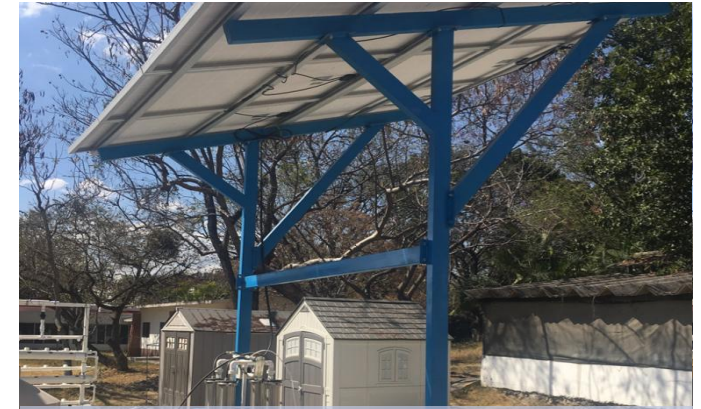
Desalinizadora solar de 5 m 3 /d
