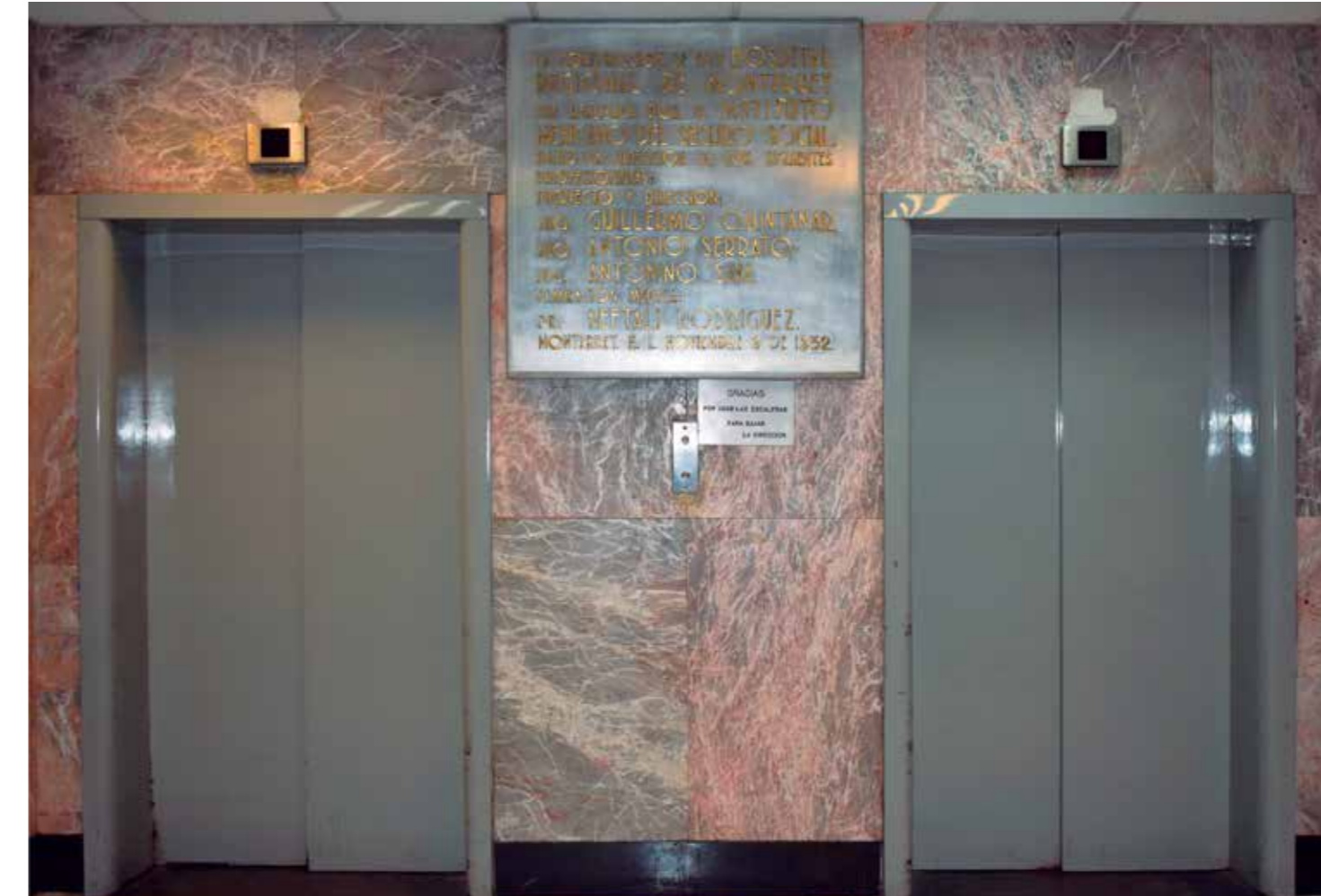
ELEVADORES PRINCIPALES DE LA UMAE HOSPITAL DE TRAUMATOLOGÍA Y ORTOPEDIA NÚM 21, MONTERREY, NVO. LEÓN Foto: Archivo del Departamento de Prestaciones Sociales de la Delegación IMSS Nuevo León.
