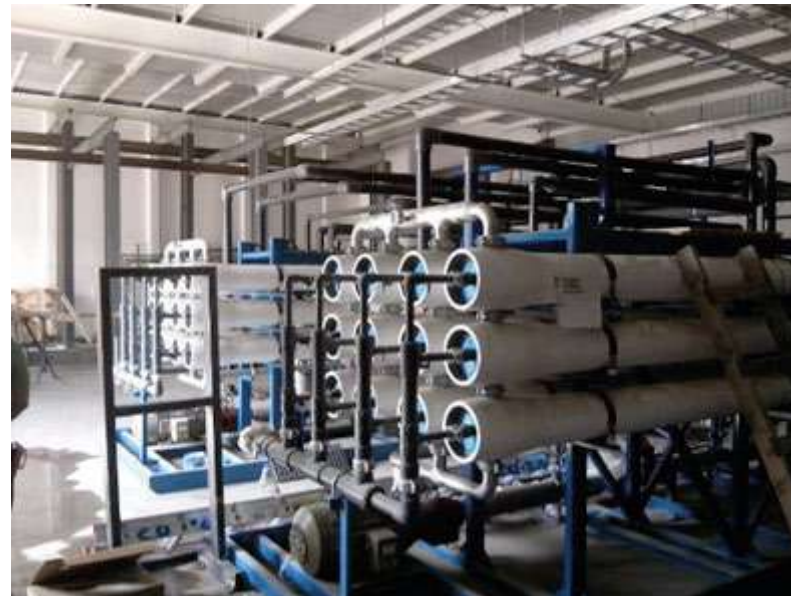
Sistema de ósmosis inversa
