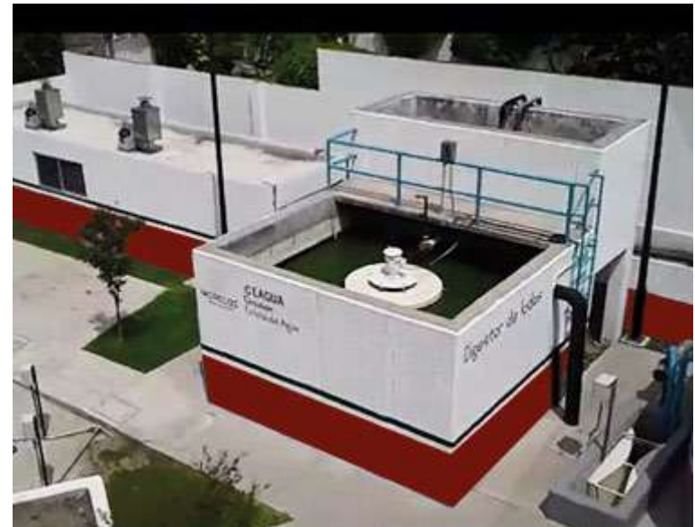
Digestor aerobio de lodos
