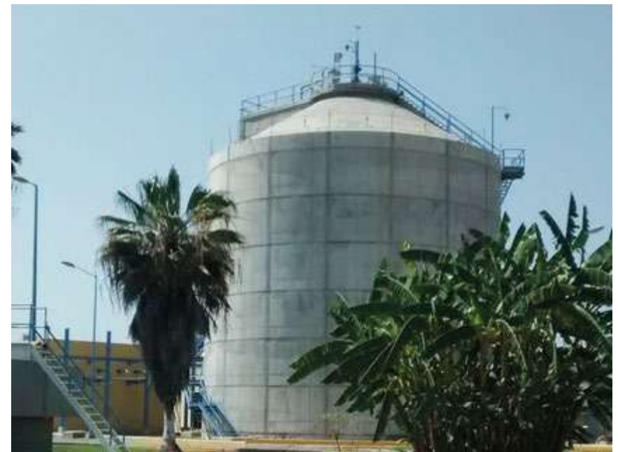
Digestor anaerobio de lodos
