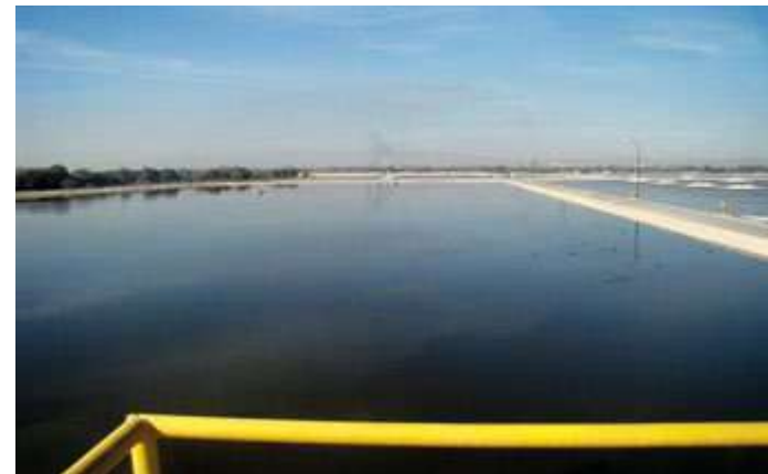
Laguna de Maduración
