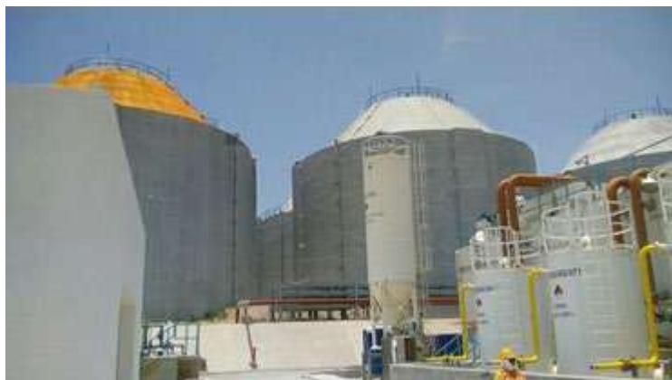
Digestor anaerobio de lodos
