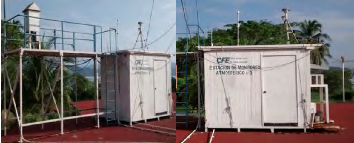
Figura 26. Exterior de la caseta de monitoreo ubicada en el techo de un edificio.
