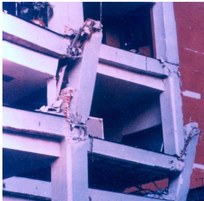
Figura 2.43 Falla de conexión viga-columna
