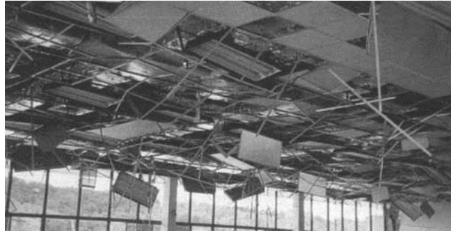
Figura 2.56 Daño en cielos rasos
