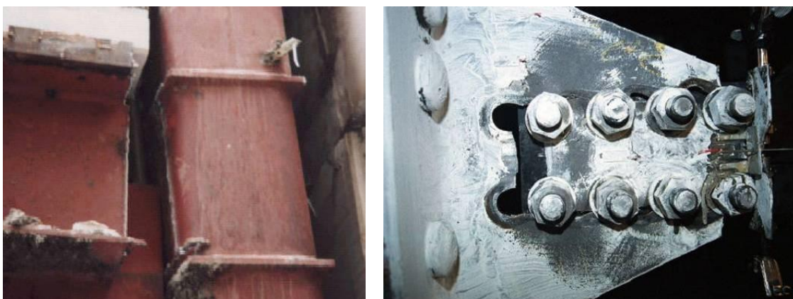
Figura 2.50 Falla en conexiones a) Soldadura; b) conexión atornillada (Foto Ismael Vázquez, 2009)
