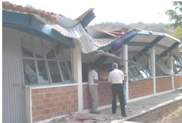
Figura 2.39 Colapso de techo
