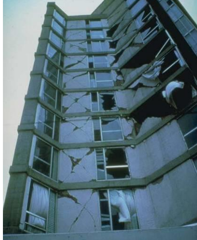
Figura 2.54 Daños en elementos exteriores
