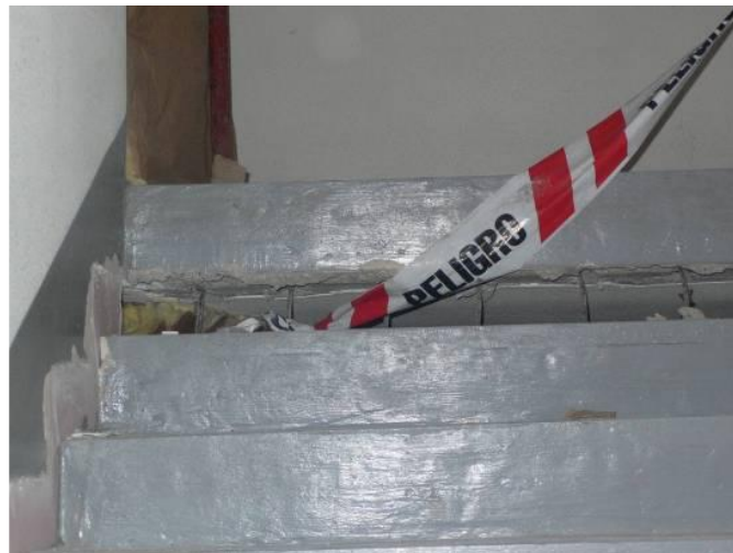
Figura 2.57 daño en escaleras
