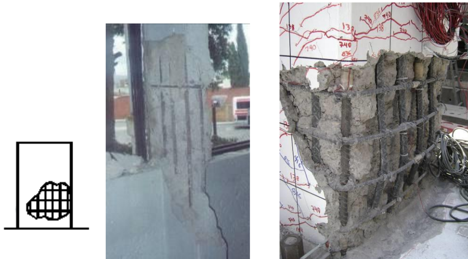
Figura 2.47 Desprendimiento del concreto y acero de refuerzo expuesto
