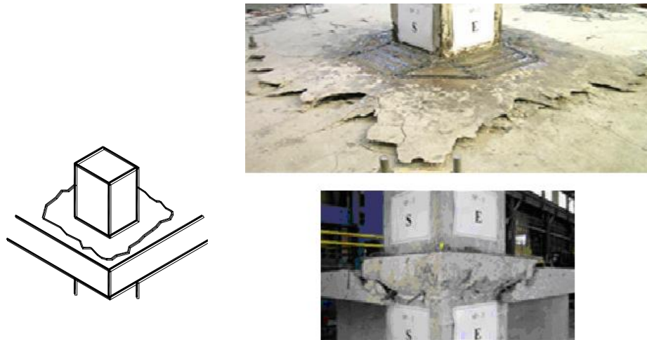
Figura 2.40 Grietas alrededor de columnas (Widianto y otros, 2006)
