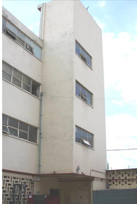
Figura 3.31 Marcos o muros que no llegan a la cimentación
