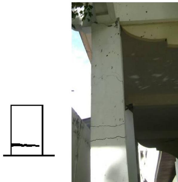
Figura 2.46 Grietas por flexión: a) esquemático; b) en columnas
