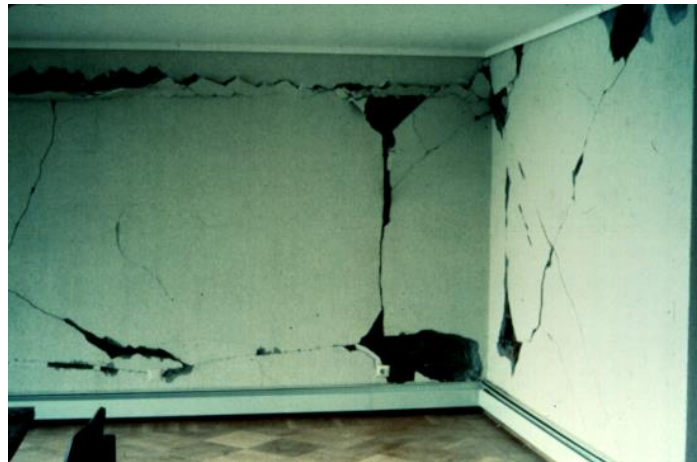
Figura 2.55 Daño en uros divisorios
