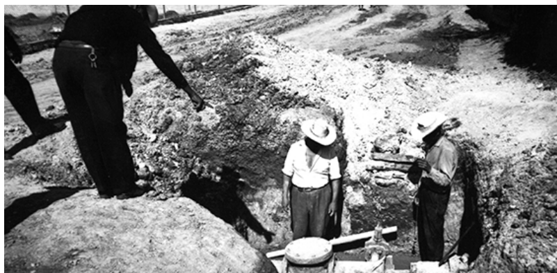
Vista de la caja de registro para la conducción de agua potable, 1970, Cárdenas, San Luis Potosí. CONAGUA-AHA, Fondo Colección Fotográfica, Caja 24, Expediente 576.
