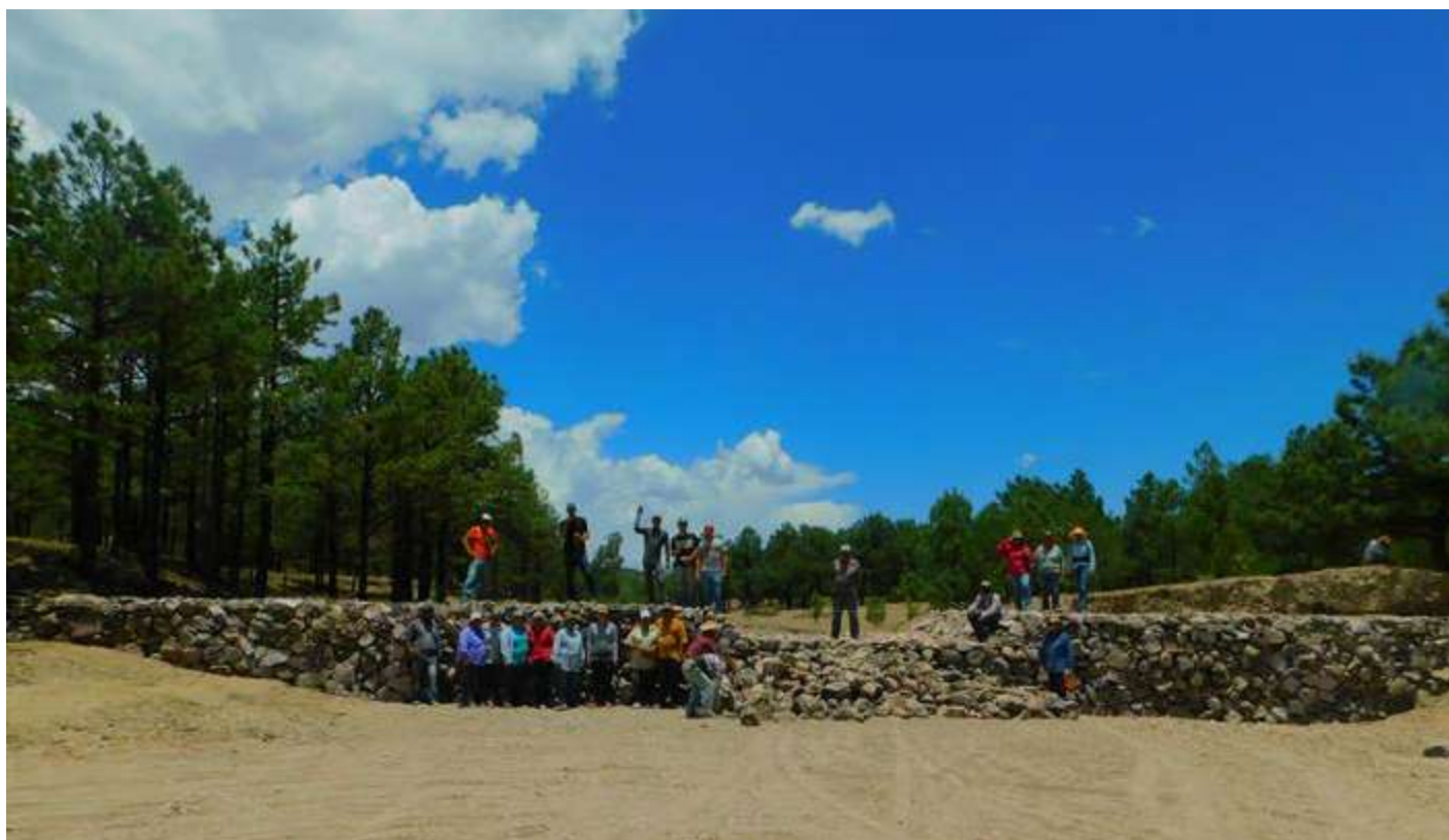
Trabajos de construcción de represas de piedra acomodada en el PN Cumbres de Majalca.
