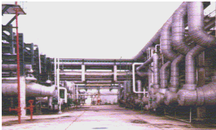
FIGURA 5. AISLAMIENTO DE CABEZALES DE VAPOR
