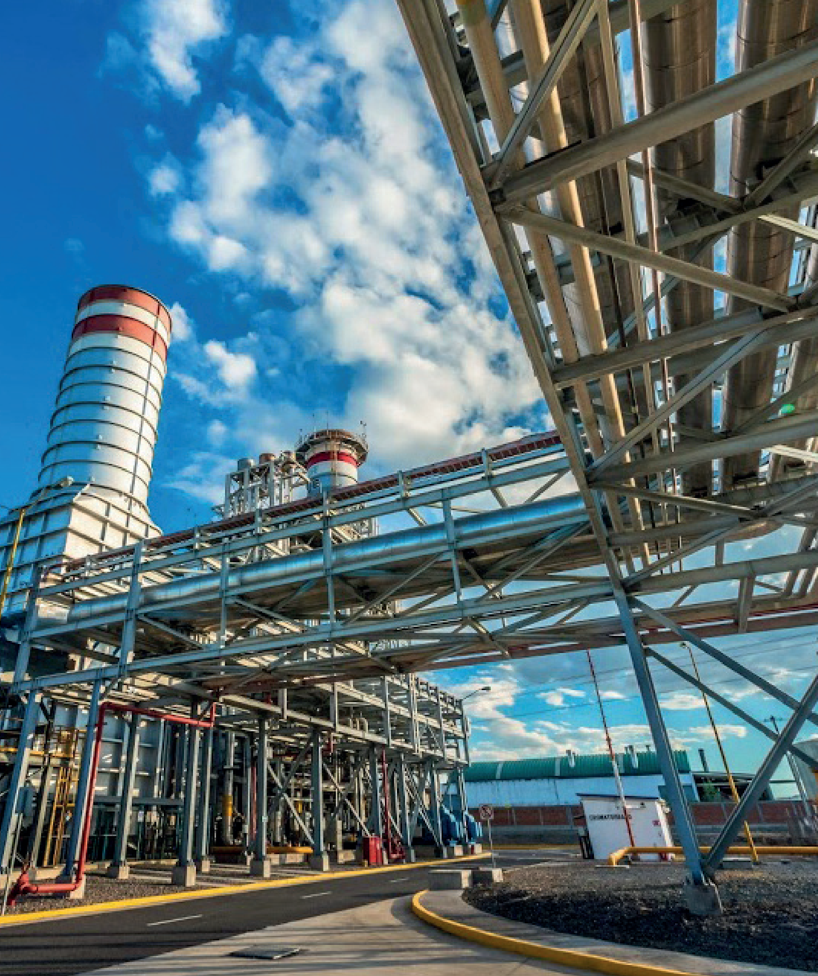
Fotografía 11. Central Ciclo Combinado, "El Sauz", Generación I. Santiago de Querétaro, Querétaro. CFE.
