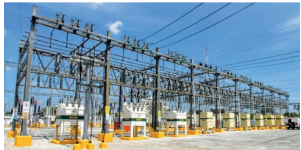
Fotografía 17. Subestación eléctrica, "Itzaes". Mérida, Yucatán. 2021. CFE.
