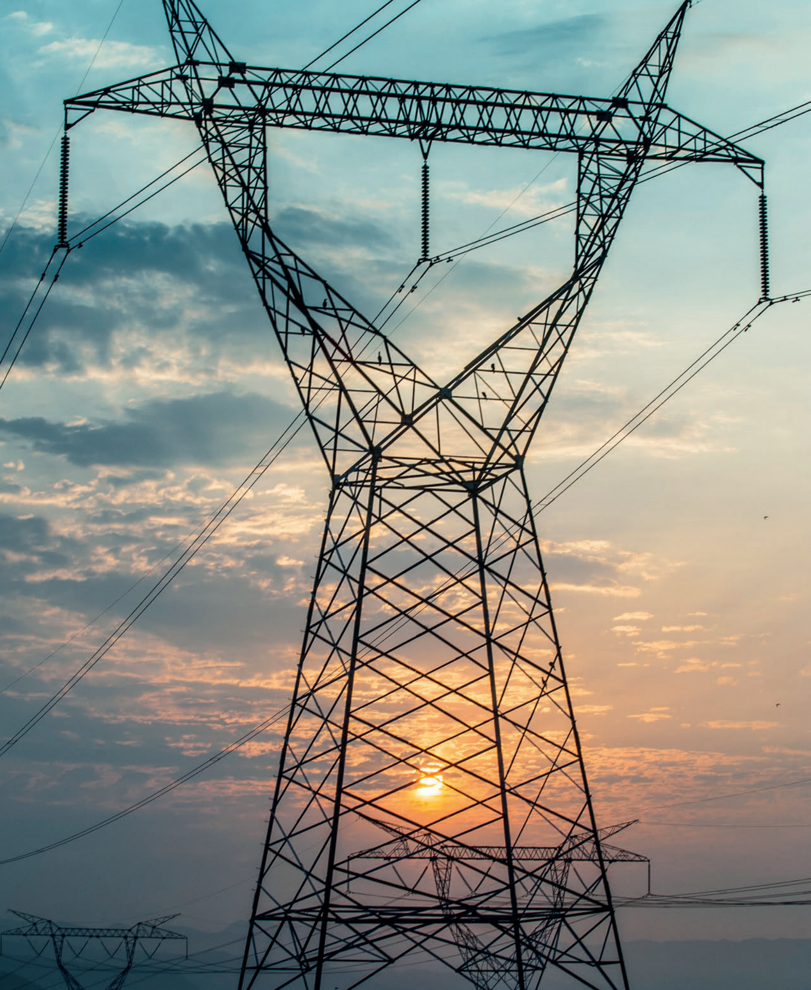
Fotografía 34. Torre de transmisión, Manzanillo, Colima. CFE.
