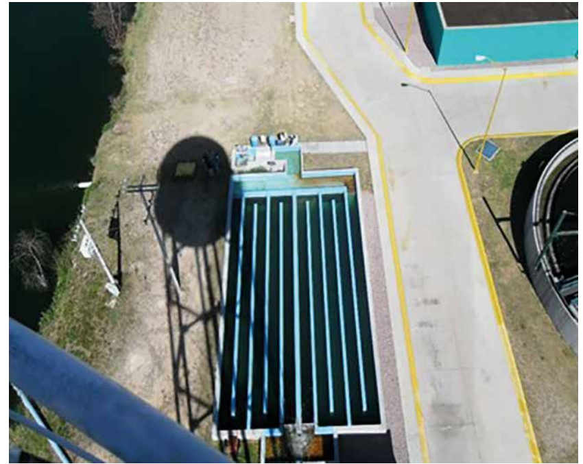
Tanque de contacto con cloro
