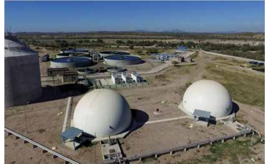
Almacenamiento de biogás y equipos de cogeneración
