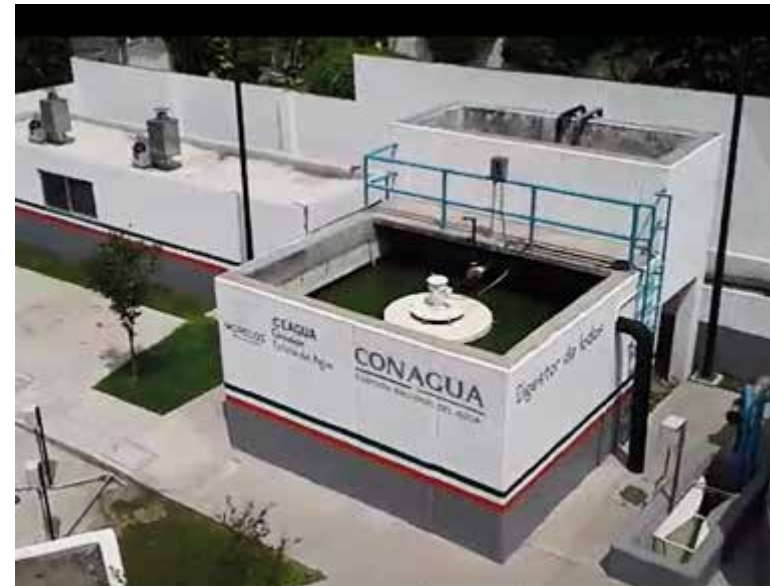
Digestor aerobio de lodos
