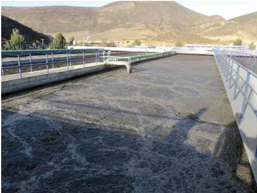
Zanjas de oxidación
