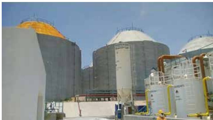
Digestor anaerobio de lodos
