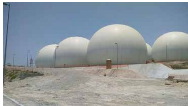
Almacenamiento de biogás
