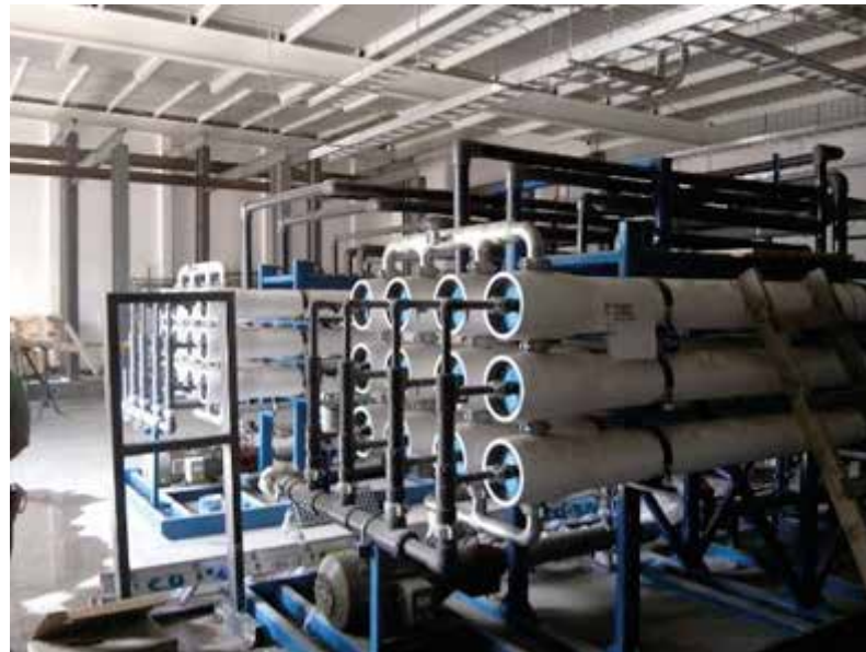
Sistema de ósmosis inversa
