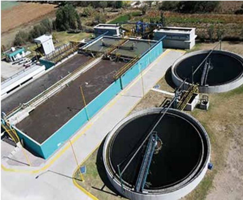
Reactores aerobios y sedimentadores secundarios
