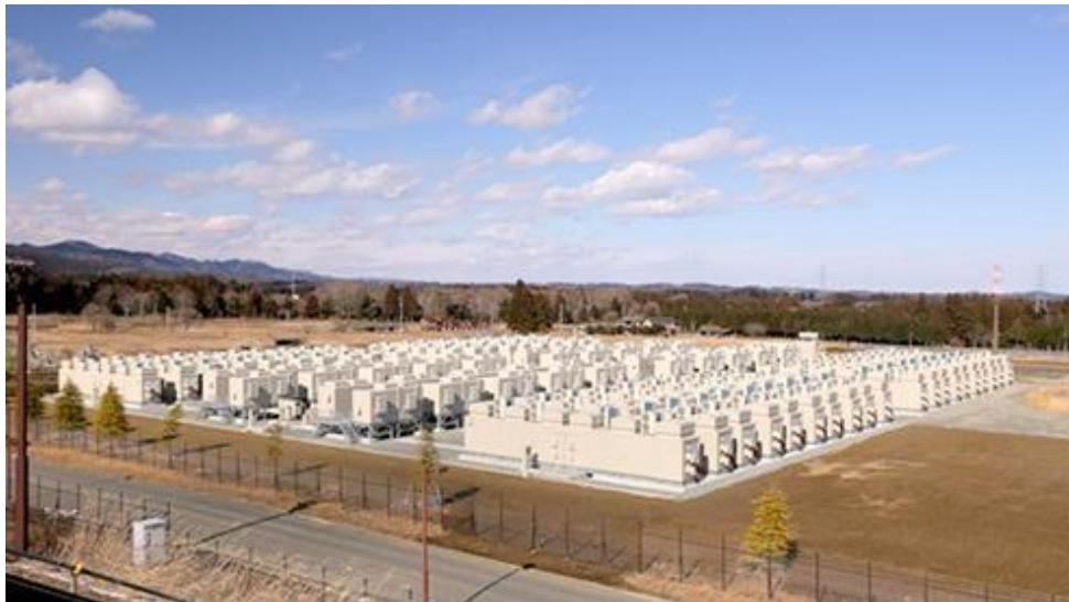
Figura 2.16. Sistema de almacenamiento Minima-Soma de Tohoku Electric Power Company. Fuente: (Toshiba, 2016)
