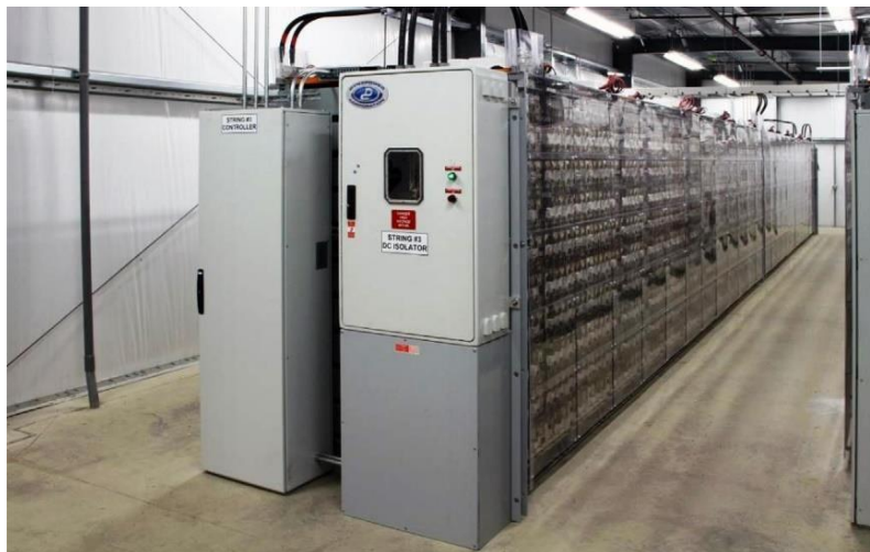
Figura 2.26. Tres cadenas de baterías instaladas. Fuente: (DOE, 2015)
