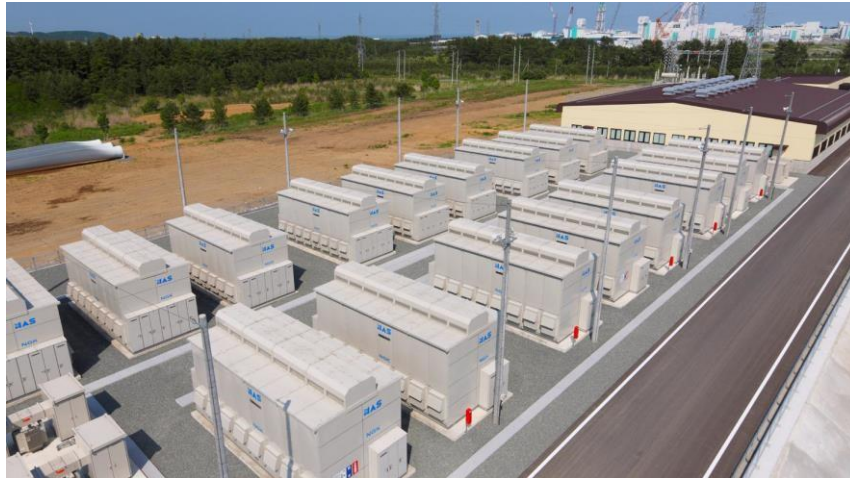
Figura 2.32. 17 conjuntos de baterías NaS de 2 MW. Fuente: (Kawakami et al., 2010)
