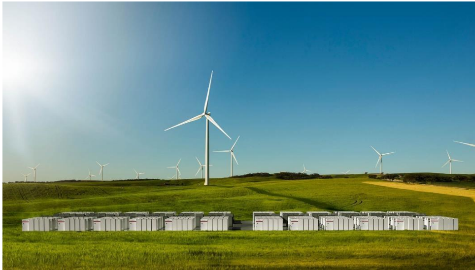
Figura 2.15. Modelo del sistema de paquete eléctrico Tesla emparejado con la Granja Eólica Hornsdale de Neoen cerca de Jamestown, Sur de Australia. Fuente: (Tesla, 2017)
