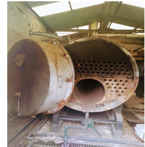
Caldera de la ARIC Lázaro Cárdenas
