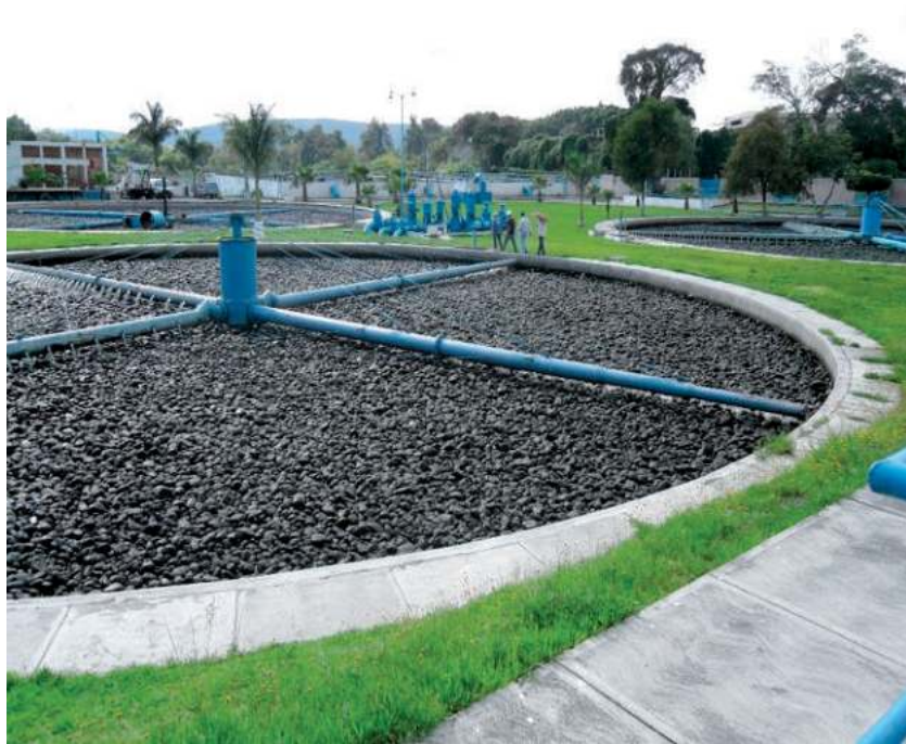
Filtro biológico (percolador)
