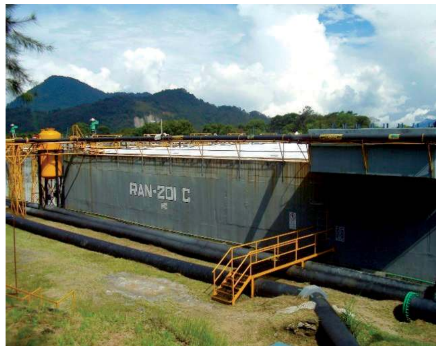
Reactor Anaerobio de Flujo Ascendente
