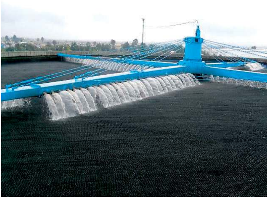
Filtro biológico (percolador)
