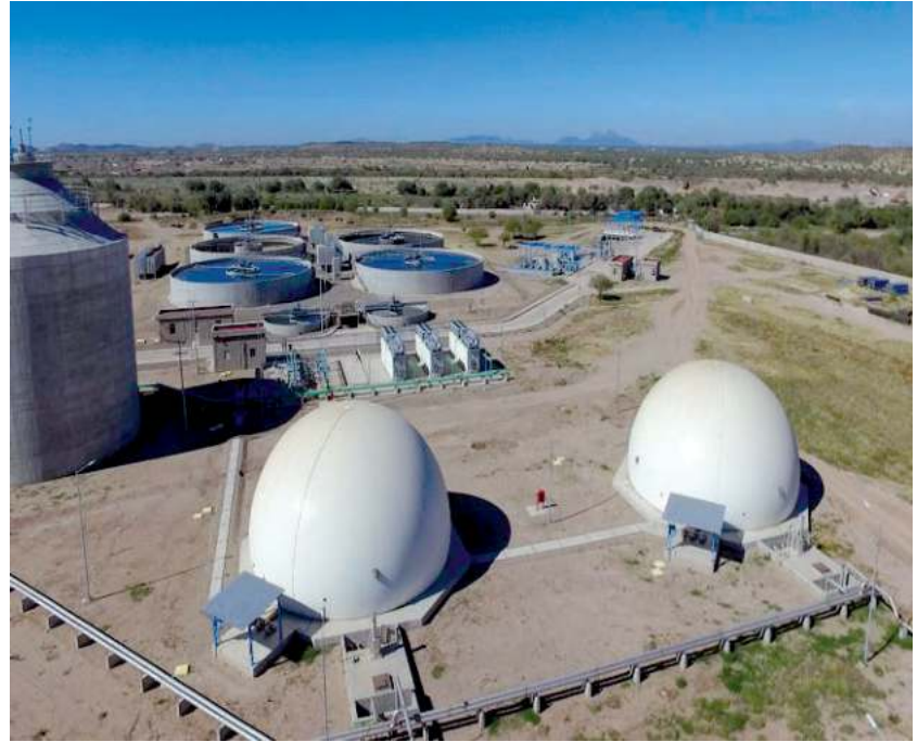
Almacenamiento de biogás
