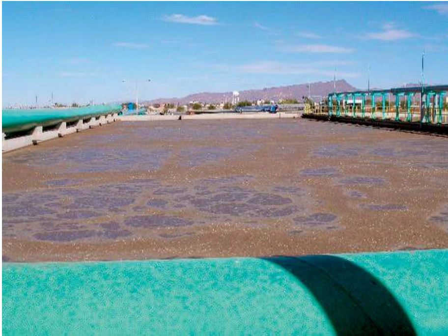
Licor mezclado del reactor aerobio
