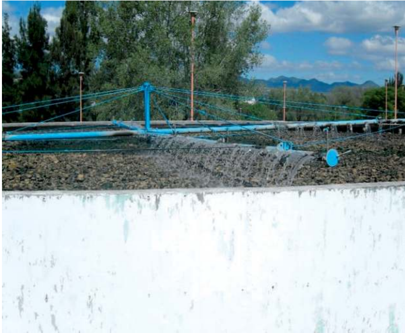
Filtro biológico (percolador)
