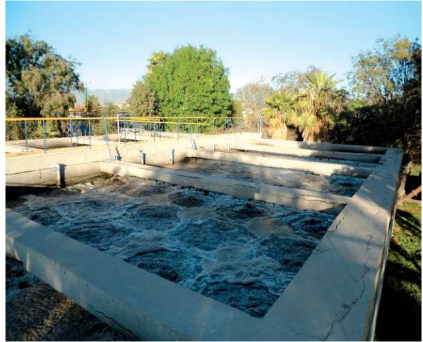
Reactor aerobio y sedimentador secundario al fondo
