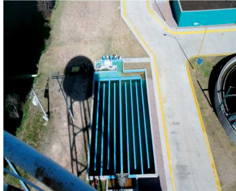
Tanque de contacto con cloro
