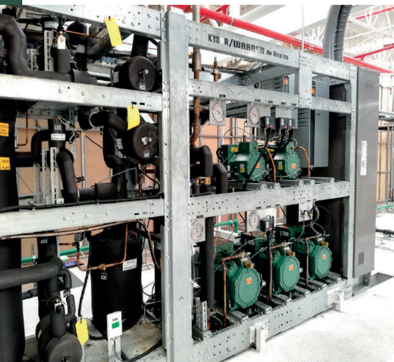
Rack paralelo de compresión para CO 2 transcrito en tienda Sendero. Fuente: Casa Ley.
