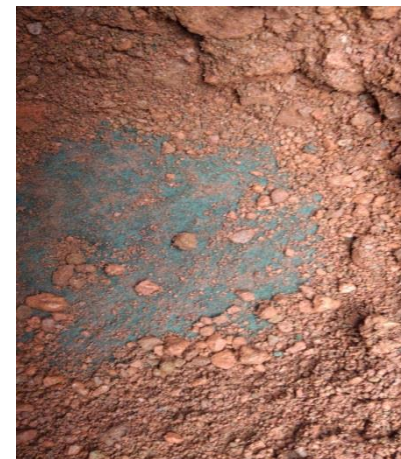
Ilustración 7. Evidencia de inexistencia de geotextil.
