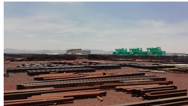
Ilustración 18. Cúmulo de elementos sin primer en Zona 2
