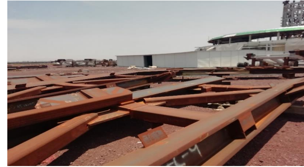
Ilustración 20. Cúmulo de elementos sin primer en Zona 4
