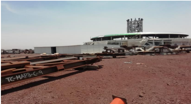
Ilustración 17. Cúmulo de elementos sin primer en Zona 1
