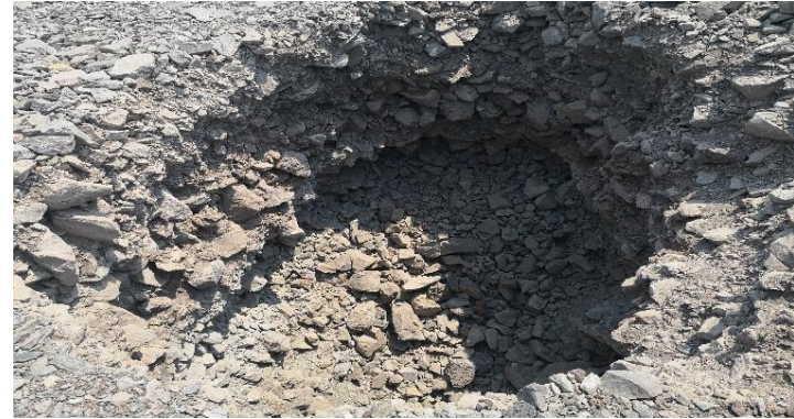
Ilustración 4. Evidencia de granulometría de agregado pequeño en capas inferiores.
