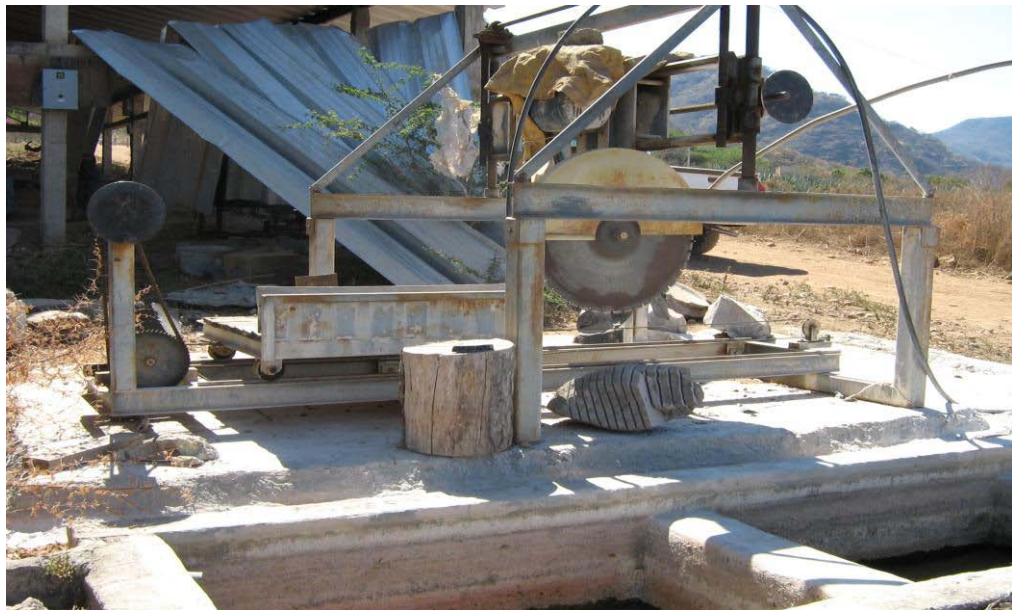
Equipo instalado en el poblado La Labor, donde se trabaja de forma interna el material que se obtiene de la localidad El Húmedo.
