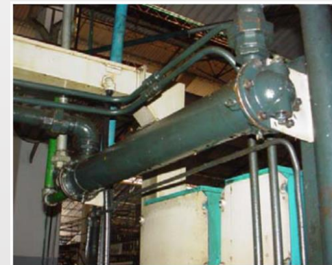
Casco y tubos
