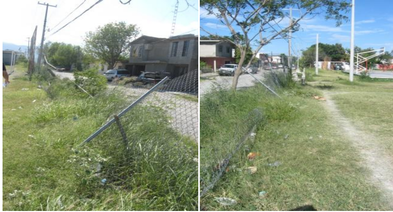
Mallas ciclónicas deterioradas en la Colonia Ampliación López Mateos.
