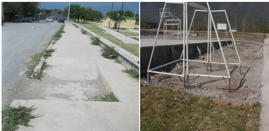
Carencia de señalización en rampa para discapacitados, y de gradas en parques Solidaridad y Colinas del Valle
