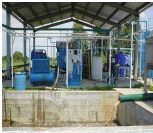
Foto 32. Planta de tratamiento de aguas residuales
