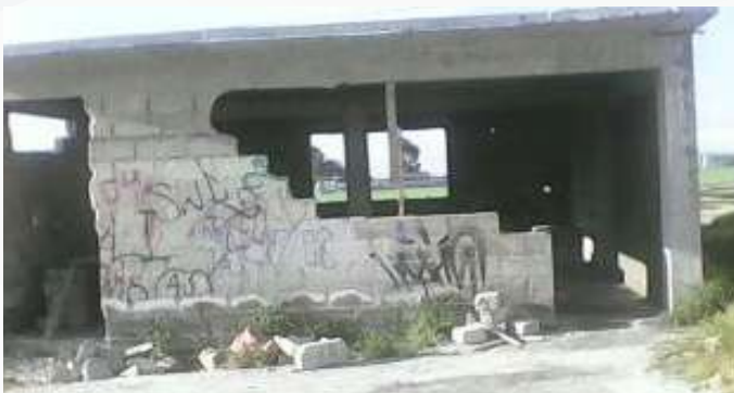
Estado en el que se encontraba el aula
