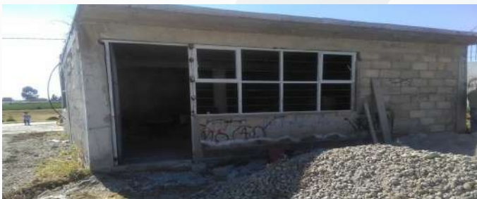
Estado en el que se encontraba el aula
