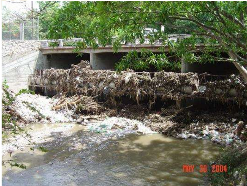
Obstrucción por tubería y basura
