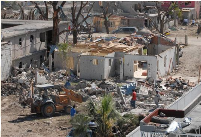
Foto: Daños en el Fraccionamiento Villa de fuentes, Piedras Negras., Coahuila. 24 de abril de 2007 (Fuente: Cortesía de Protección Civil Estatal de Coahuila)
