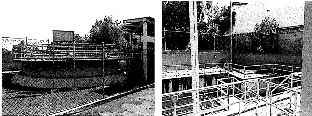
Imagen 6 (conjunto). Planta de tratamiento de aguas residuales.
