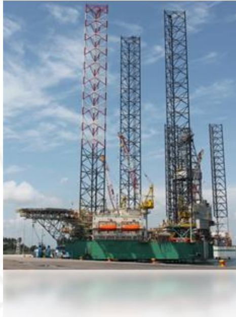
Plataforma Petrolera en Construcción, Puerto de Dos Bocas, Paraíso, Tabasco. Fuente: Secretaría de Desarrollo Económico y Turismo
