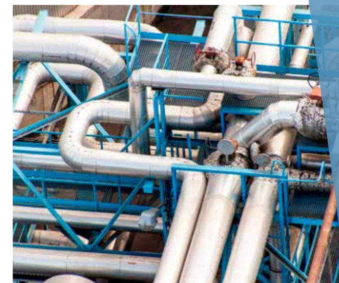
Tuberías de gas licuado
