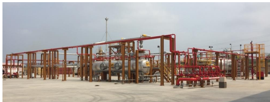
Loop de alta presión para pruebas con hidrocarburos a alta presión y escala real
