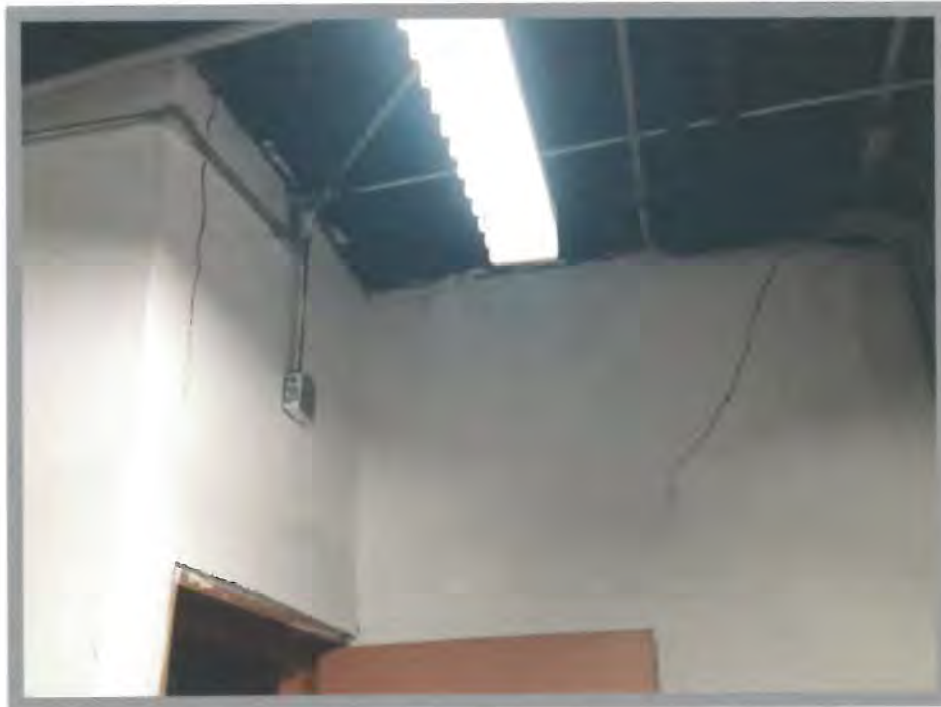
Foto 14 Daño en muro divisorio (No es estructural); sin embargo, se debe reparar inmediatamente y darle sujeción lateral
