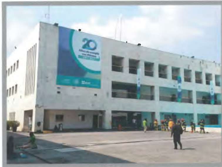
Foto 3 Plaza que cubre a los sótanos de estacionamiento y cuya losa tiene problemas de impermeabilización que está deteriorando al concreto, así como a las varillas
