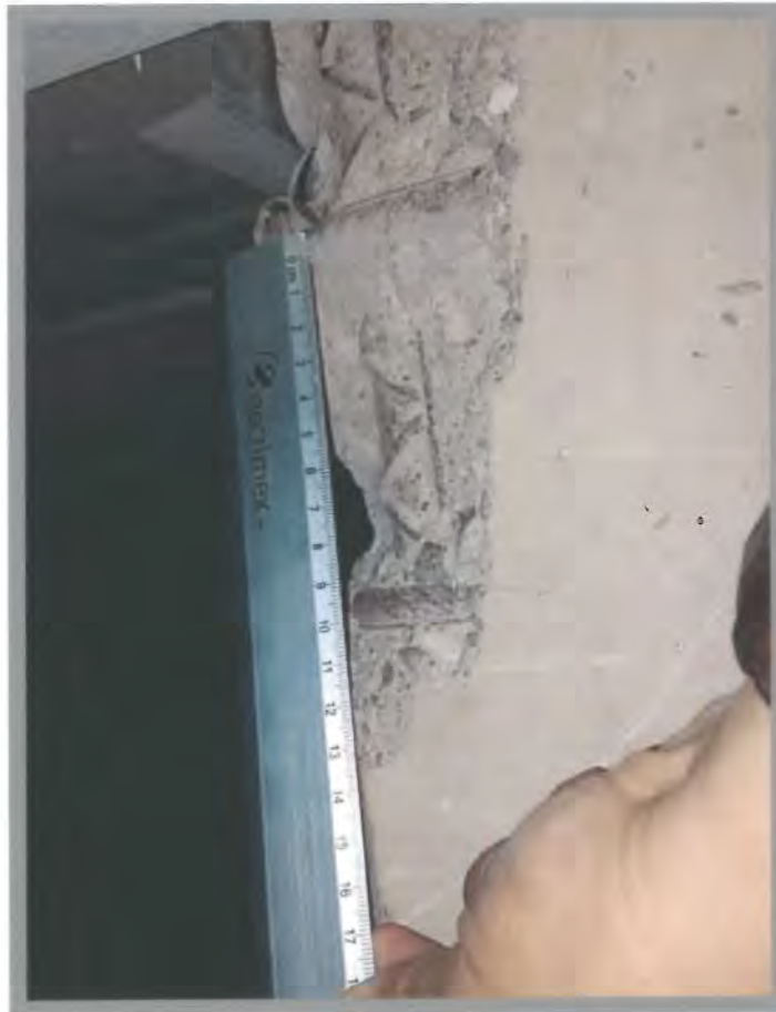
Foto 13 Separación de estribos en columnas a cada 10 cm
