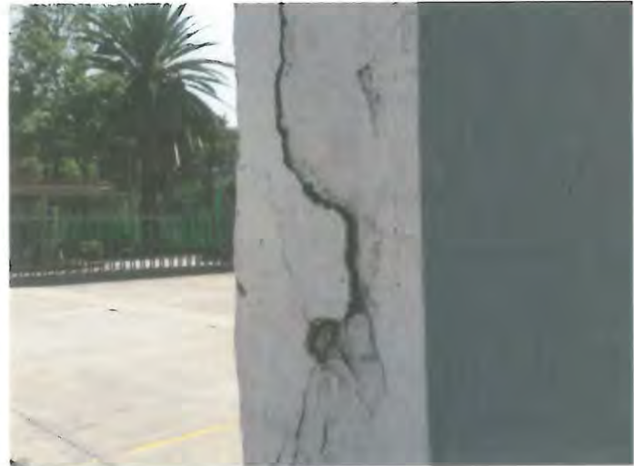
FOTO 01.- FRACTURAS EN COLUMNA DE OFICINA DE EJECUTIVO DE SERVICIOS.
