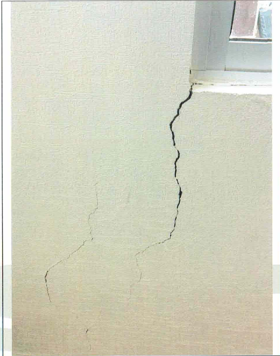
Foto 9. Falla en muro por falta de confinamiento. Se sugiere el pronto reforzamiento.
