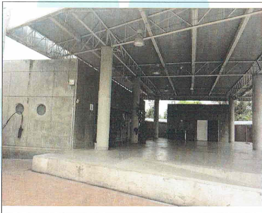
Foto 8. Oficina de operación aduanera. Sin falla alguna. Se recomienda mantenimiento a la armadura que soporta la cubierta.
