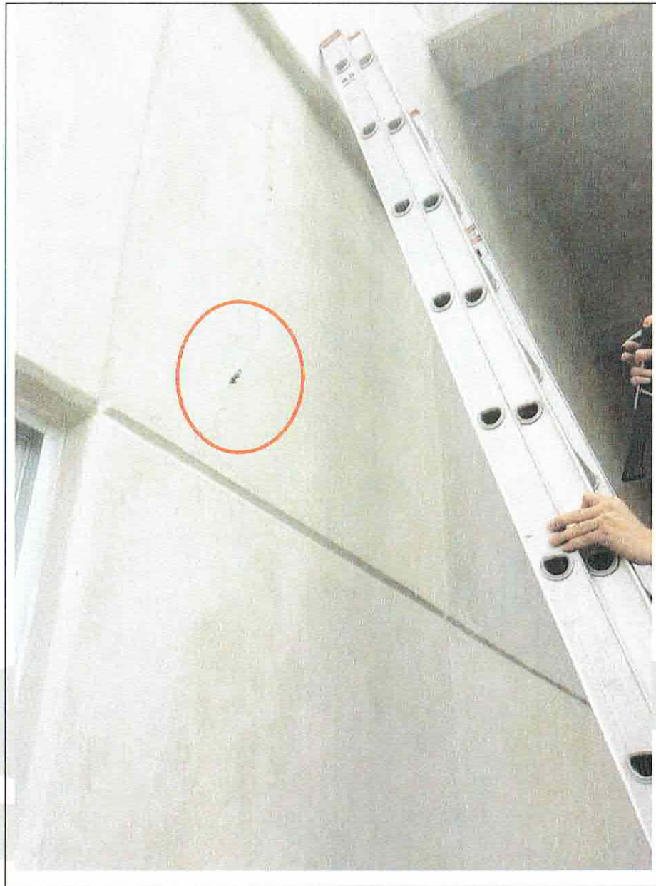
Foto 15. Calas realizadas para indagar sobre grietas expuestas en aplanados.
