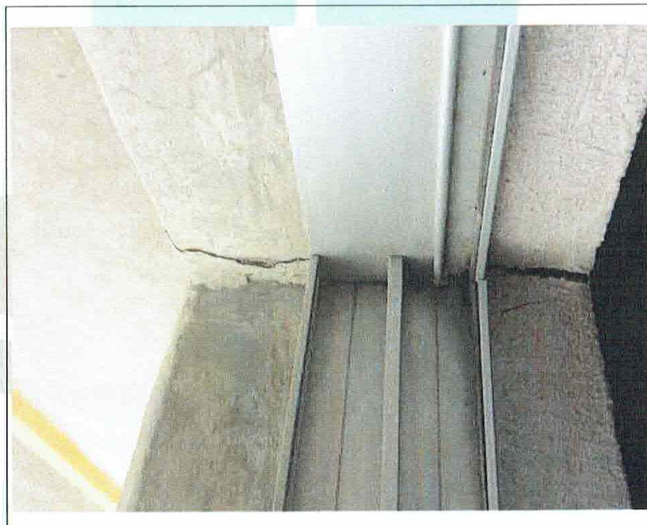
Foto 6. Muro fallado por falta de confinamiento. Es oportuno su reforzamiento aunque no representa riesgo por no ser elemento estructural.
