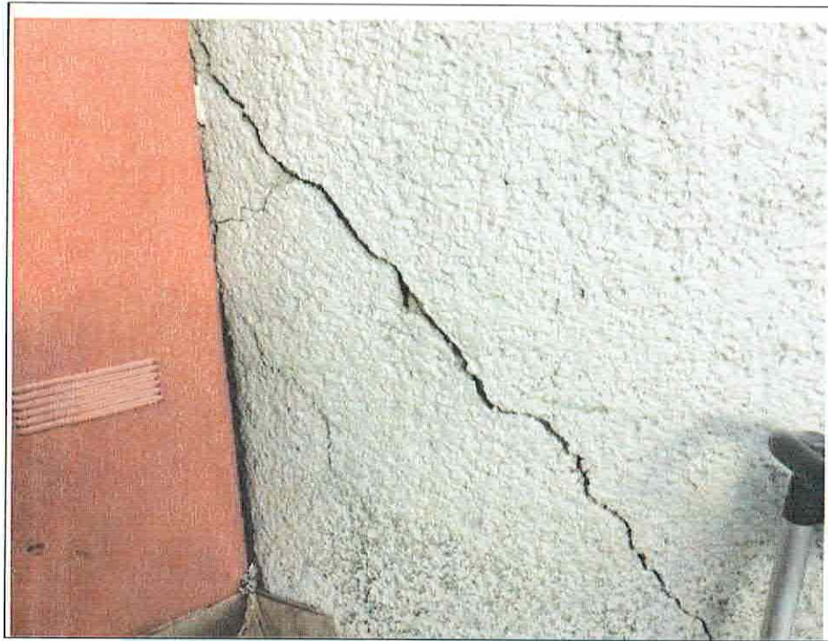
Foto 1. Muro con falla por cortante en el edificio "C" del recinto fiscal a cargo de AACESA.
