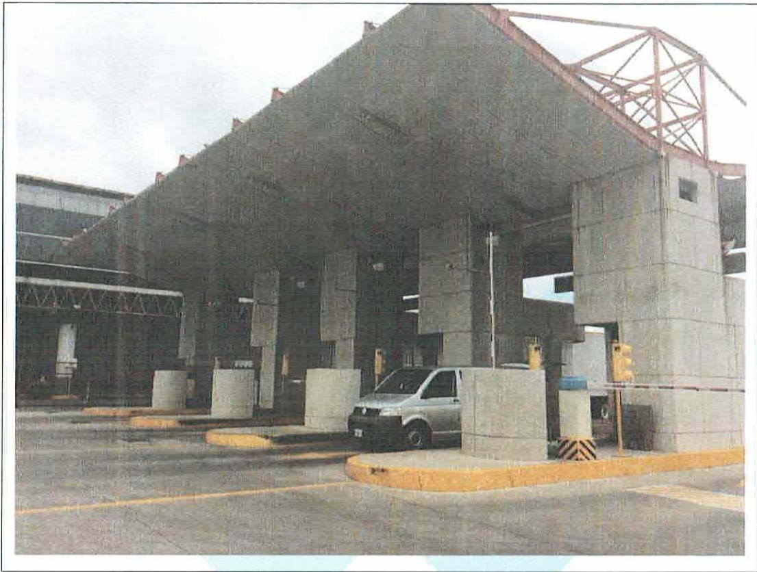
Foto 23. Casetas no presentan daño estructural pero se reporta necesidad de mantenimiento en impermeabilización y revisión en sus bajadas de agua.
