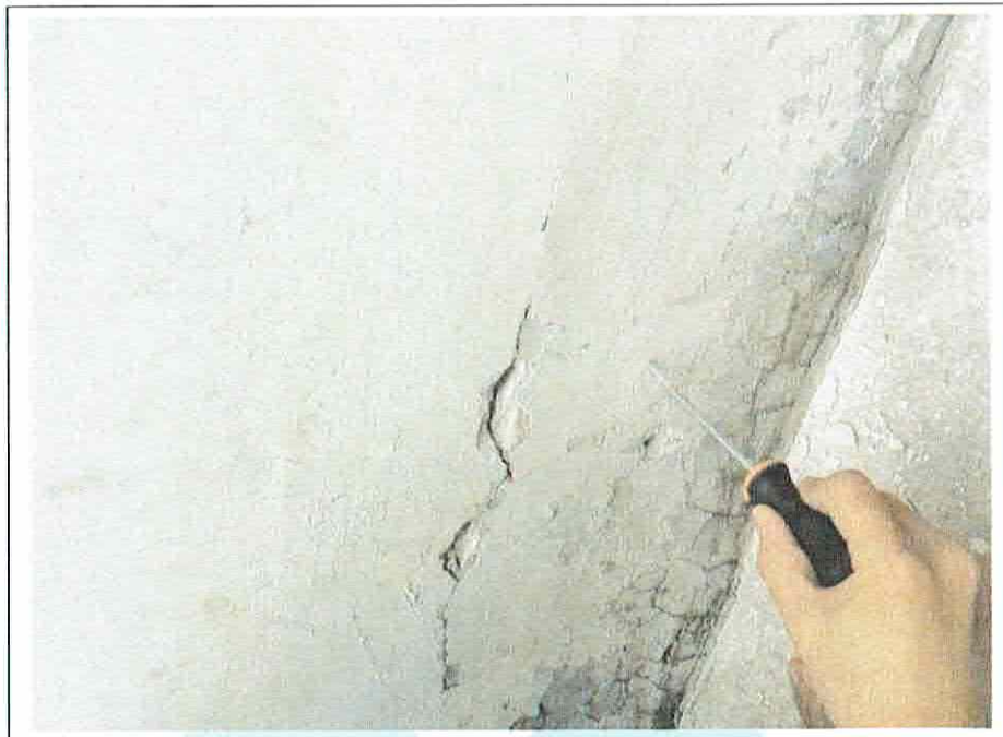
Foto 5. Grieta que indica el desprendimiento de muro divisorio al elemento estructural, no representa riesgo. Se recomienda resane.
