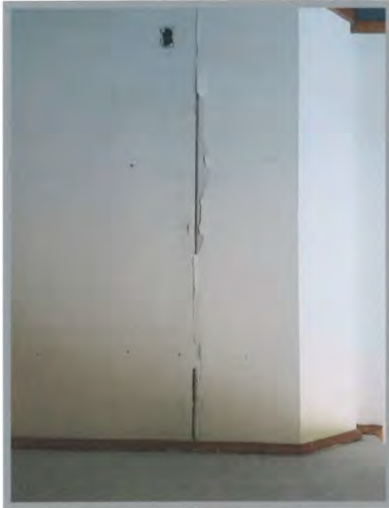
Foto 14 Separación entre columna y muro de relleno (No es daño estructural). Se deben dejar juntas y buñas entre elementos estructurales y divisorios
