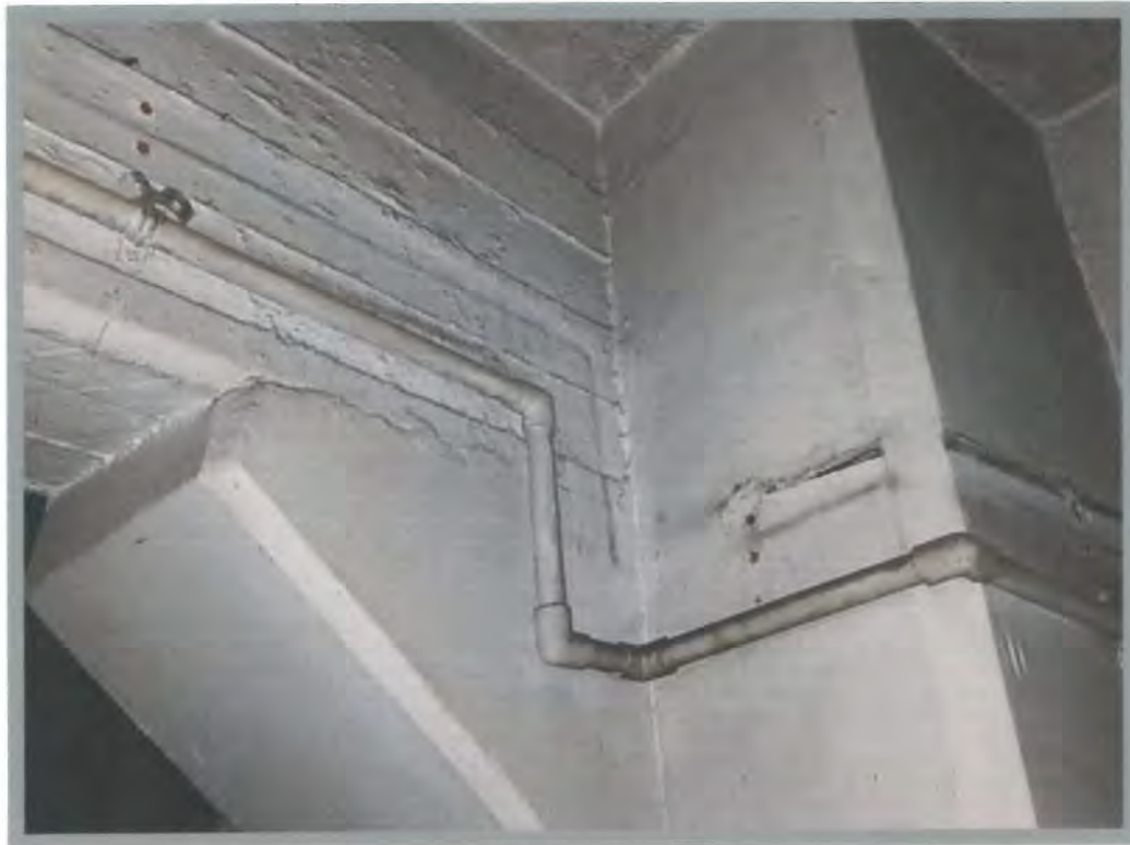
Foto 8 No hay daños estructurales en las uniones de trabe con columna
