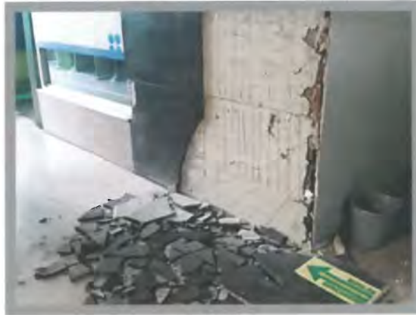
Foto 6 Caída de mármol de recubrimiento del núcleo de elevadores (No es daño estructural)
