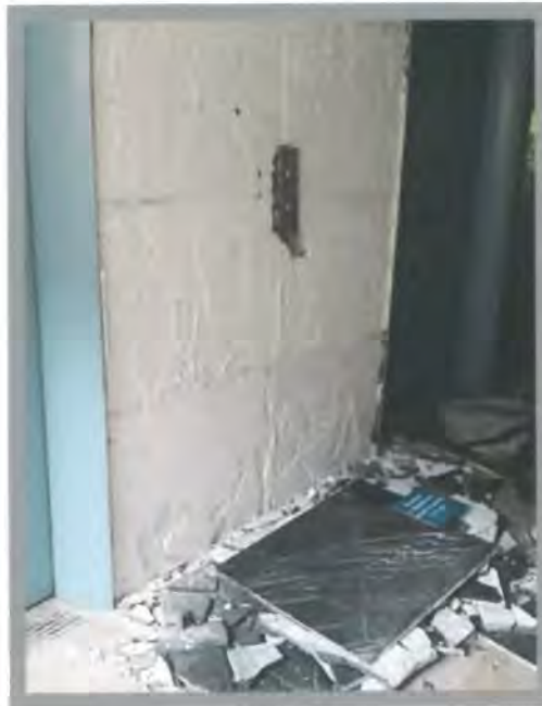
Foto 7 Caída de mármol de recubrimiento del núcleo de elevadores (No es daño estructural)
