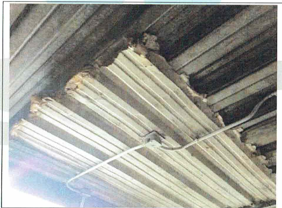
Foto 2. Parche de concreto en losa, representa riesgo local en el sistema de losa. Se recomienda atenderlo.
