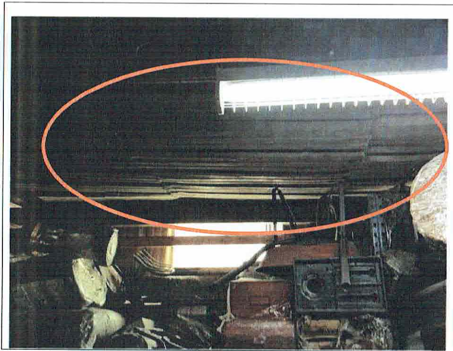
Foto 1. Se presenta deflexión excesiva en sistema de losa, sin embargo en la parte superior no se percibe. Error en construcción. Se recomienda atenderlo a la brevedad.
