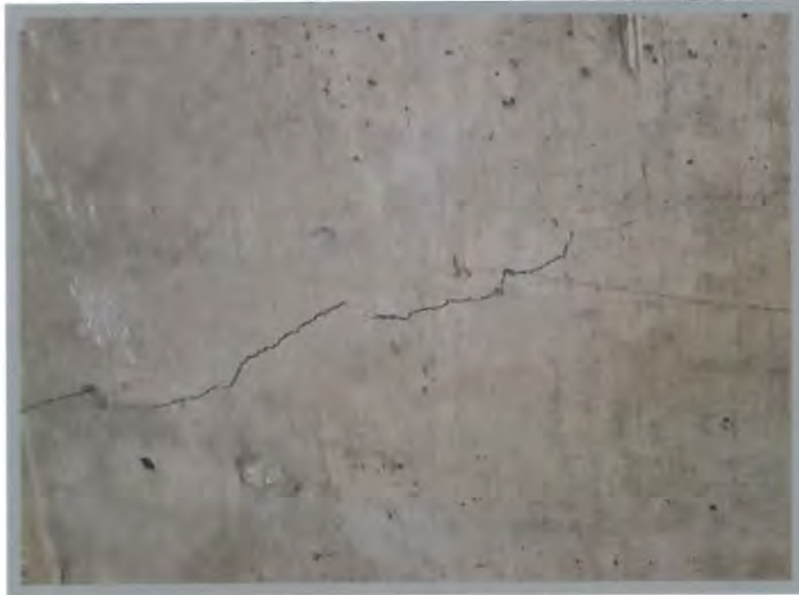
Foto 6 Fisuras superficiales en muro de concreto de rigidez
