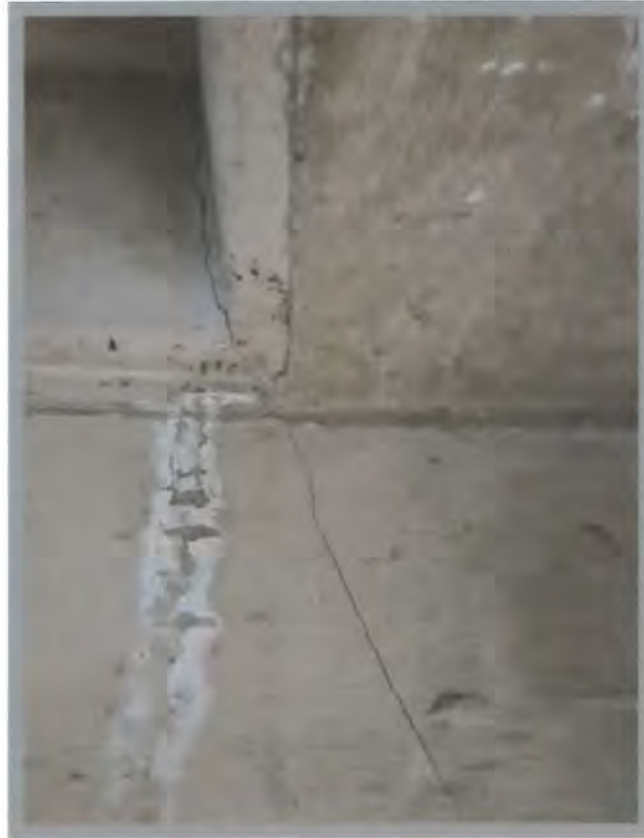
Foto 7 Fisuras superficiales en nervaduras de losa reticular
