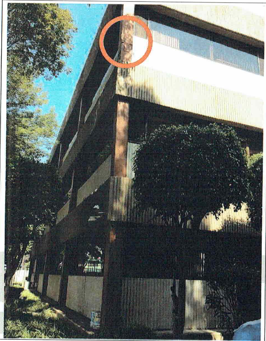
Foto 9. Se señala las el punto donde se aprecia cierto desplomo en columnas correspondientes a ese eje, sin afectar su integridad estructural y geométrica.
