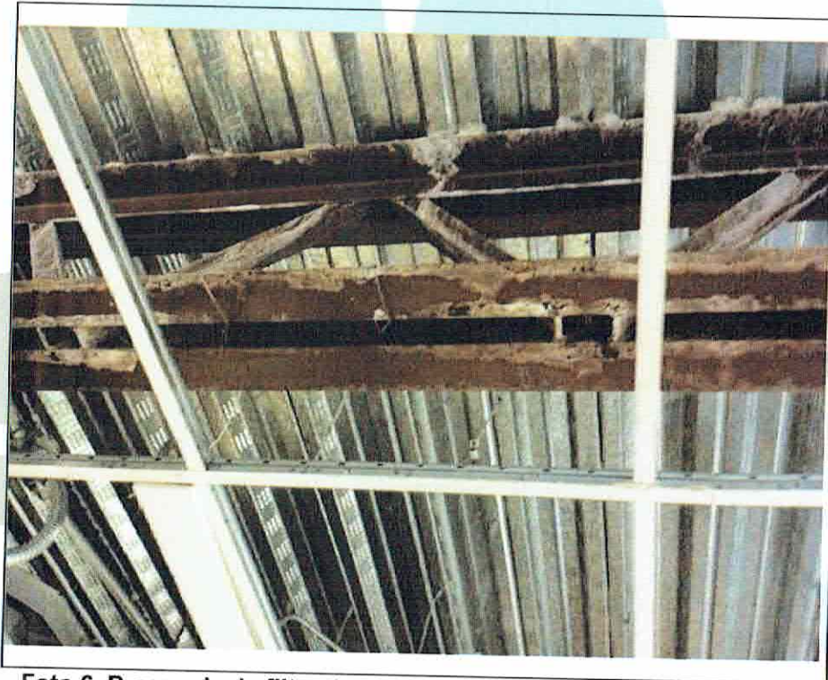
Foto 6. Presencia de filtraciones de agua, se sugiere mantenimiento.
