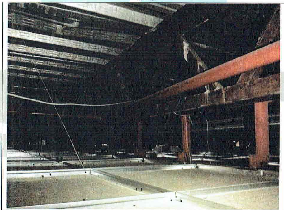
Foto 2. Celosías hacen la labor de soporte para los sistemas de losa, elementos y conexiones sin falla. Sistema de losacero en losa de azotea.
