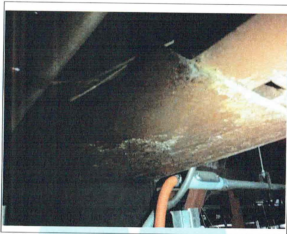
Foto 3. Conexiones a momento entre celosías y columna son falla alguna, se observa presencia de humedad.
