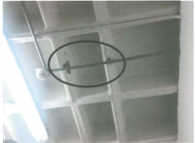
FOTO 06.- NO REALIZAR TRABAJOS SOBRE LA ESTRUCTURA
