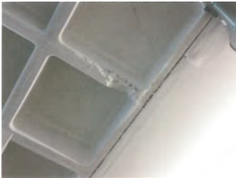
FOTOS 04.- FISURAS EN CASETONES DE LOSA
