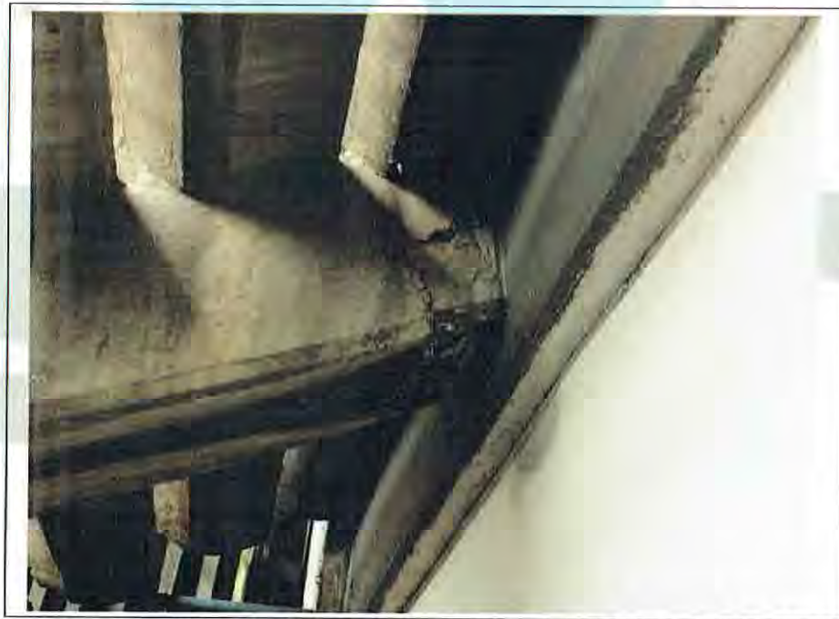
Foto 2. Es apreciable la falla en la alfarda, presente en más del 50% del elemento.
