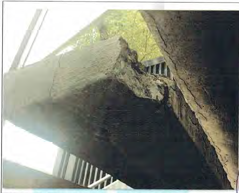
Foto 1. Muestra el estado de deterioro en el que se encuentran los escalones de acceso a la estancia infantil del I.S.S.S.T.E..
