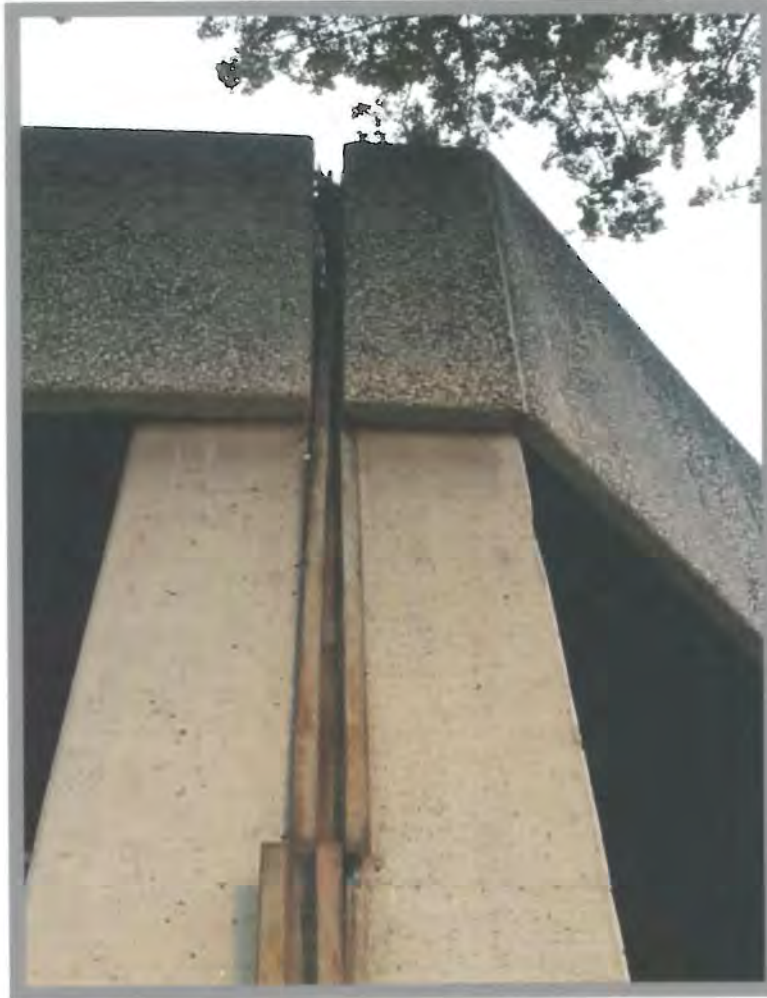
Foto 5 Choque en pretil de azotea entre junta de edificios (vista desde abajo). Cuerpo H con F
