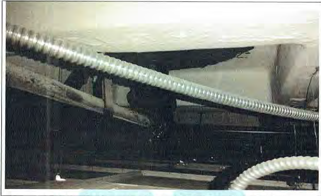
Foto 13. Las instalaciones hidro-sanitarias de la estancia requieren mantenimiento, así como sus muebles de baño. Se reportan escurrimientos al primer nivel. A pesar de esto los elementos estructurales se encuentran en buen estado.
