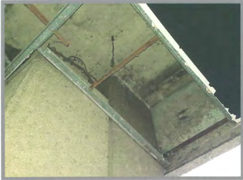
Foto 12 Se aprecia que existen columnas falsas que se agrietaron como la de la izquierda
