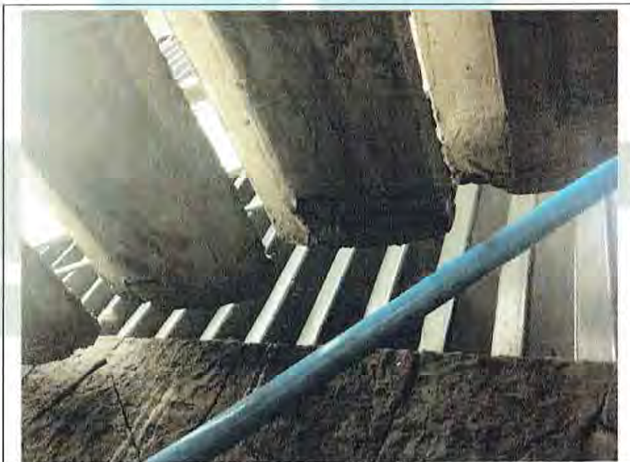
Foto 4. Escalones con deterioro considerable. Importante darles solución pues es el único acceso a la estancia infantil.
