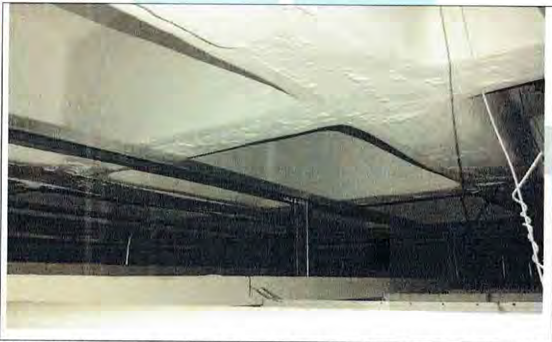
Foto 12. Esta imagen muestra el sistema de losa nervada presente en las dos losas del edificio.
