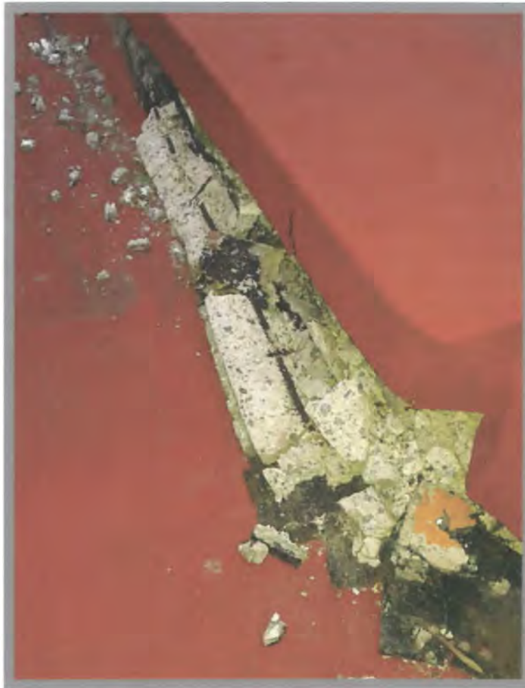
Foto 3 Choque en pretil de azotea entre junta de edificios (vista desde la azotea). Es la unión entre cuerpos H y F
