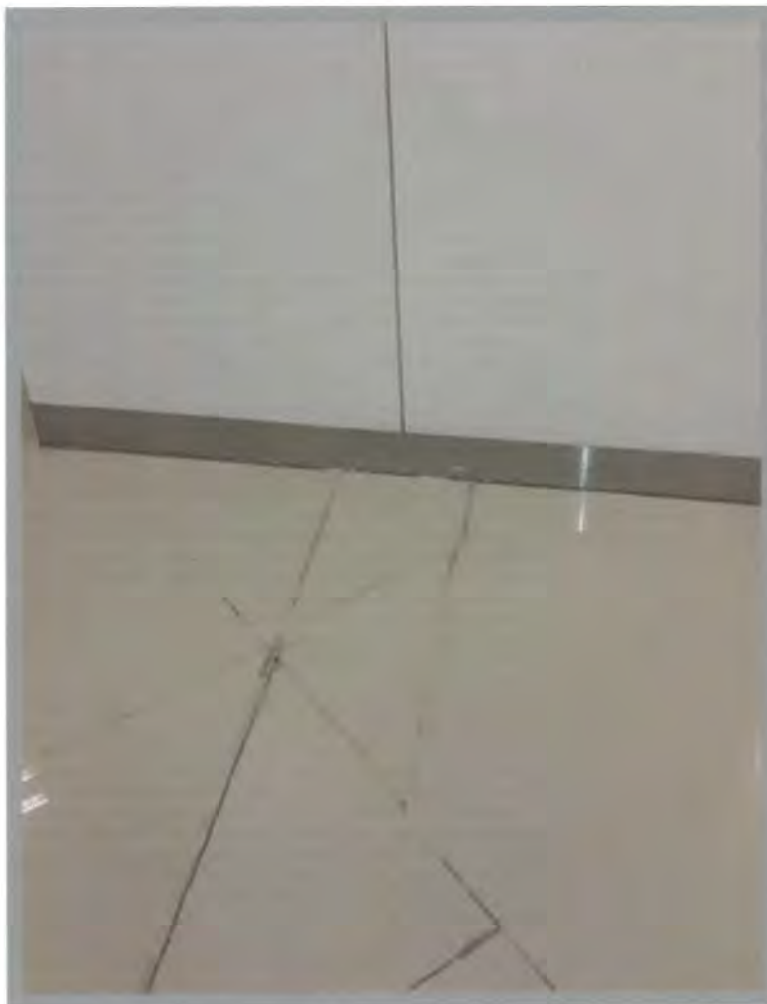
Foto 9 Daño en acabado de piso en la unión entre cuerpos
