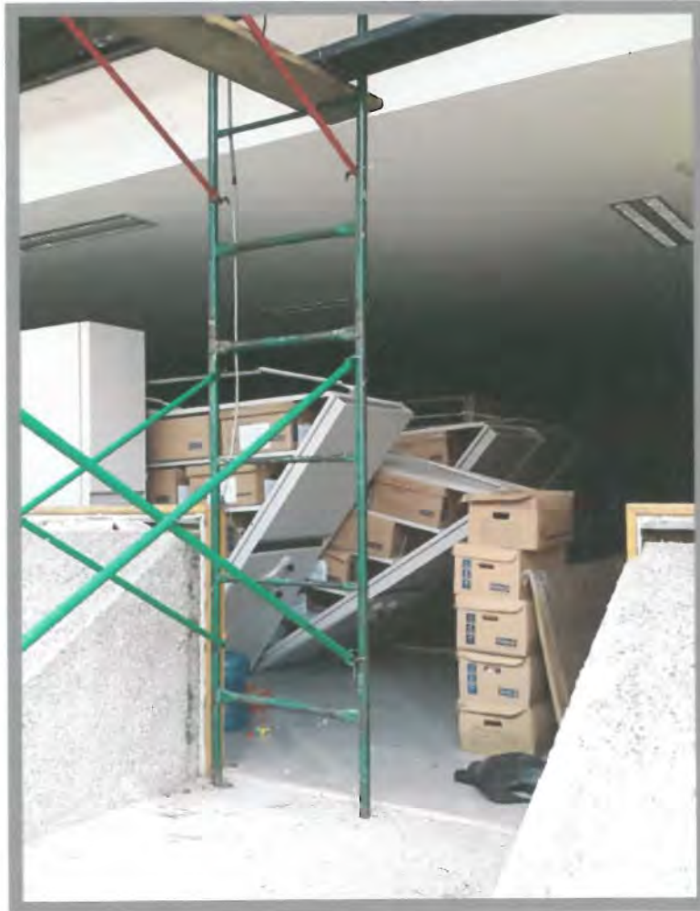
Foto 17 Caída de archiveros por las deformaciones de los edificios
