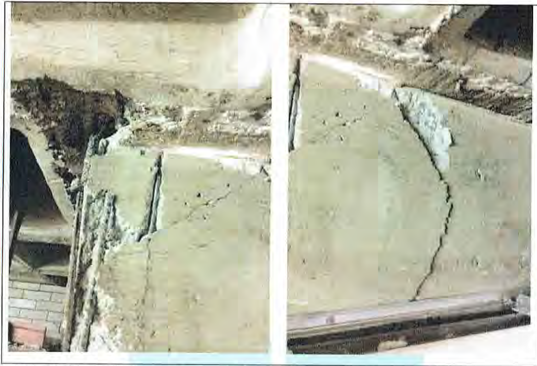
Foto 14. En el nivel superior que da lugar a la estancia infantil, existe un elemento NO estructural que tiene por uso sostener cancelería y/o muros divisorios. Presentó falla el elemento pero NO es un elemento rigidizante en la estructura.
