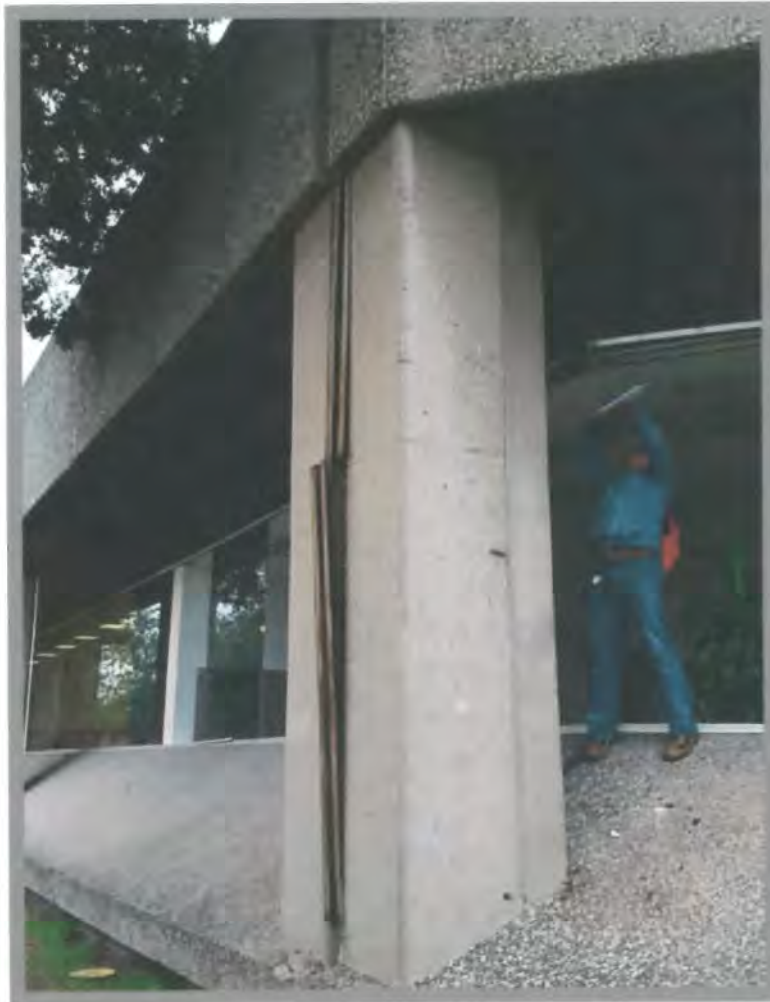
Foto 6 Choque en pretil de azotea entre junta de edificios (vista desde abajo). Cuerpo H con F. Inspección detallada
