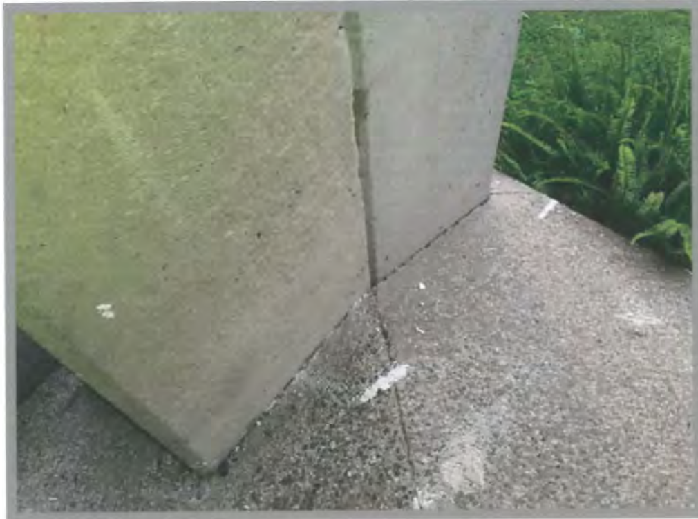
Foto 13 Columna falsa por acabado arquitectónico o para alojar instalaciones y columna estructural sin daños
